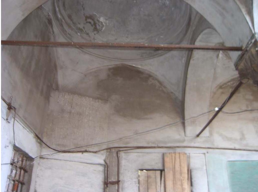
Fot. 5.42 Revaklı avluda Z5 önündeki köşe kubbe ve kapı üzerinde oluşan üçgen alan.
