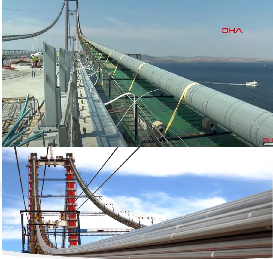
Şekil 2.8. 1915 Çanakkale Asma Köprüsü kule ana kablolar (URL-18)
