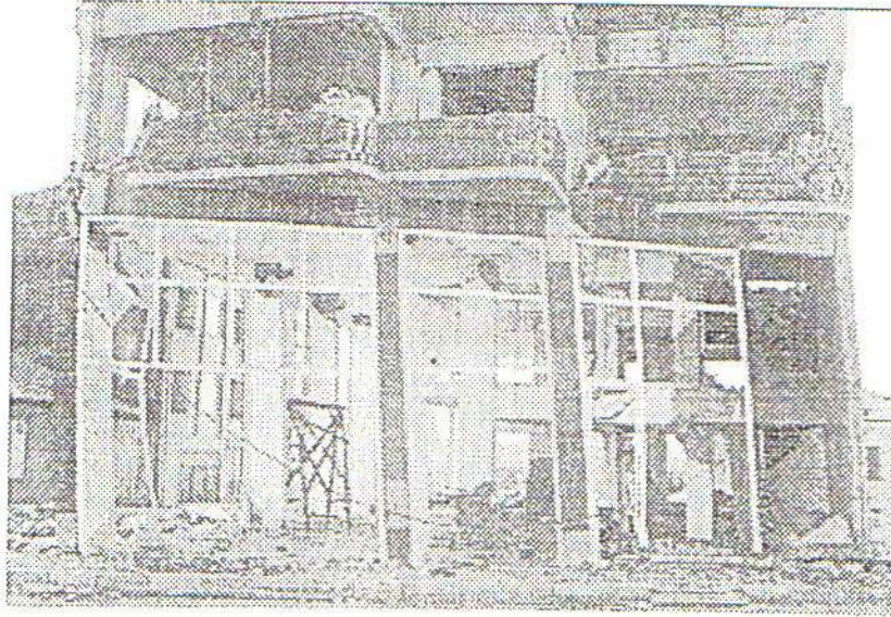
Şekil 5.12. Yumuşak Kattan Dolayı Hasar Uğramış Bina
