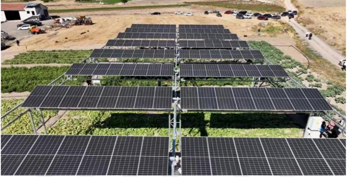
Şekil 16. Güneş izleyicili fotovoltaik panelleri (Aydınlatma, 2024)
