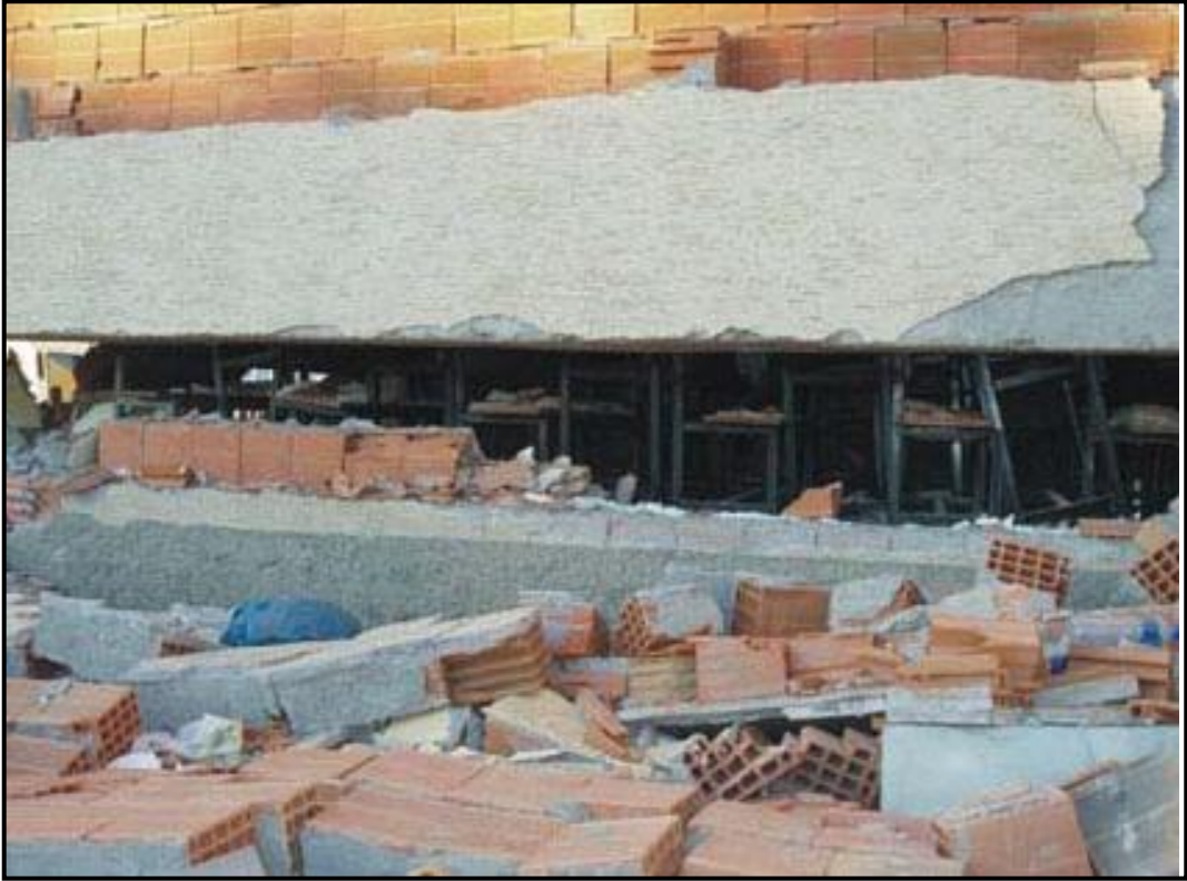
Şekil 4.19 Çeltiksuyu Yatılı Bölge Okulu giriş kattaki kolonların kırılması sonucu 2. ve 3. katların giriş kattaki dersanelerdeki demir profillerden yapılmış sıraların üzerine oturmuş hali [16]
