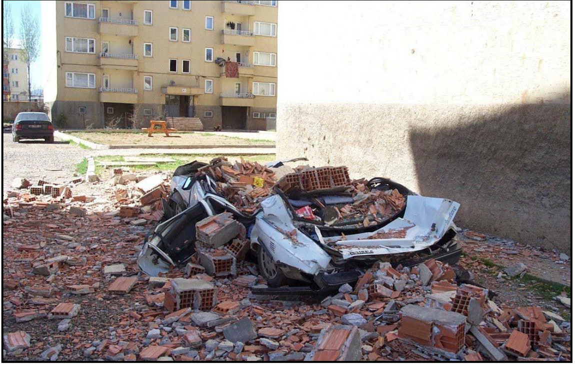
Şekil 4.16 Çatı çökmesi ve meydana getirdiği hasar [12]
