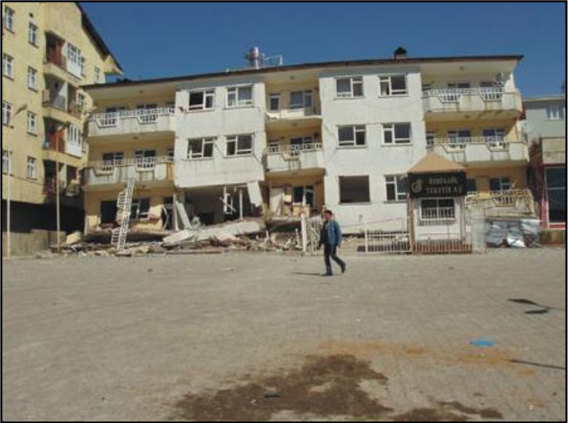
Şekil 4.7 Bingöl kent merkezinde depremde giriş katı mukavemetsizliği nedeniyle ağır hasar görmüş bina [16]
