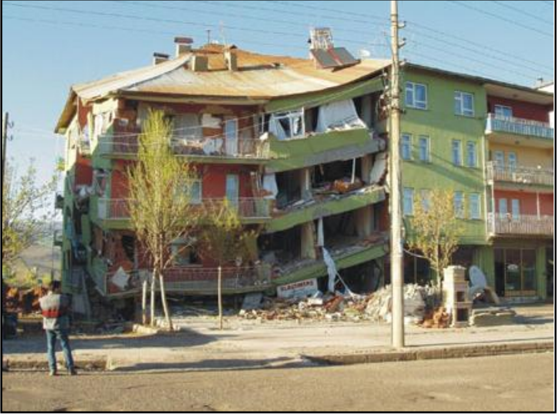
Şekil 4.8 Bingöl kent merkezinde depremde giriş katı mukavemetsizliği nedeniyle ağır hasar görmüş bina [16]
