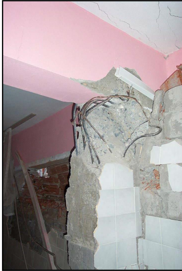
Şekil 4.11 Donatı kusurları (Kolon-Kiriş bağlantı hataları) [12]
