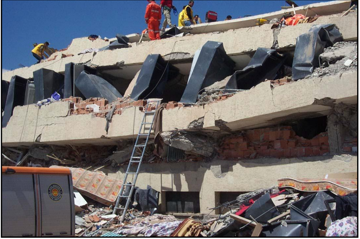
Şekil 4.20 Çeltiksuyu Yatılı Bölge Okulu yatakhane bloğunda iki kat arasındaki kolonların kırılması sonucu üst kat döşemesinin demirden yapılmış eşya dolaplarının üzerine oturması [12]
