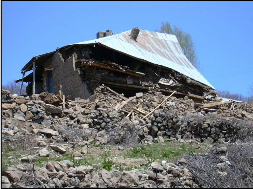
Şekil 4.5 Yetersiz dayanıma sahip yığma bina [21]
