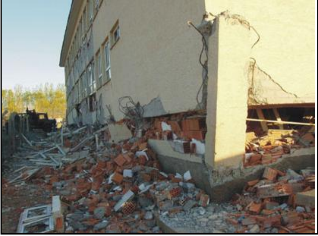
Şekil 4.18 Kolonların kırılması sonucu 2. ve 3. katları giriş katı üzerine oturmuş olan Çeltiksuyu Yatılı Bölge Okulunun görünümü [16]
