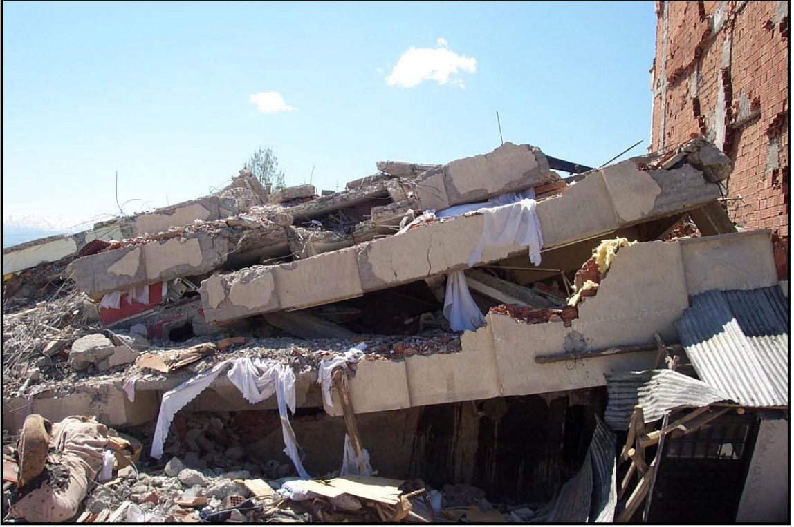
Şekil 4.14 Deprem yönetmeliğine ve standartlara uygun olmadan yapılan bir yapı örneği [12]
