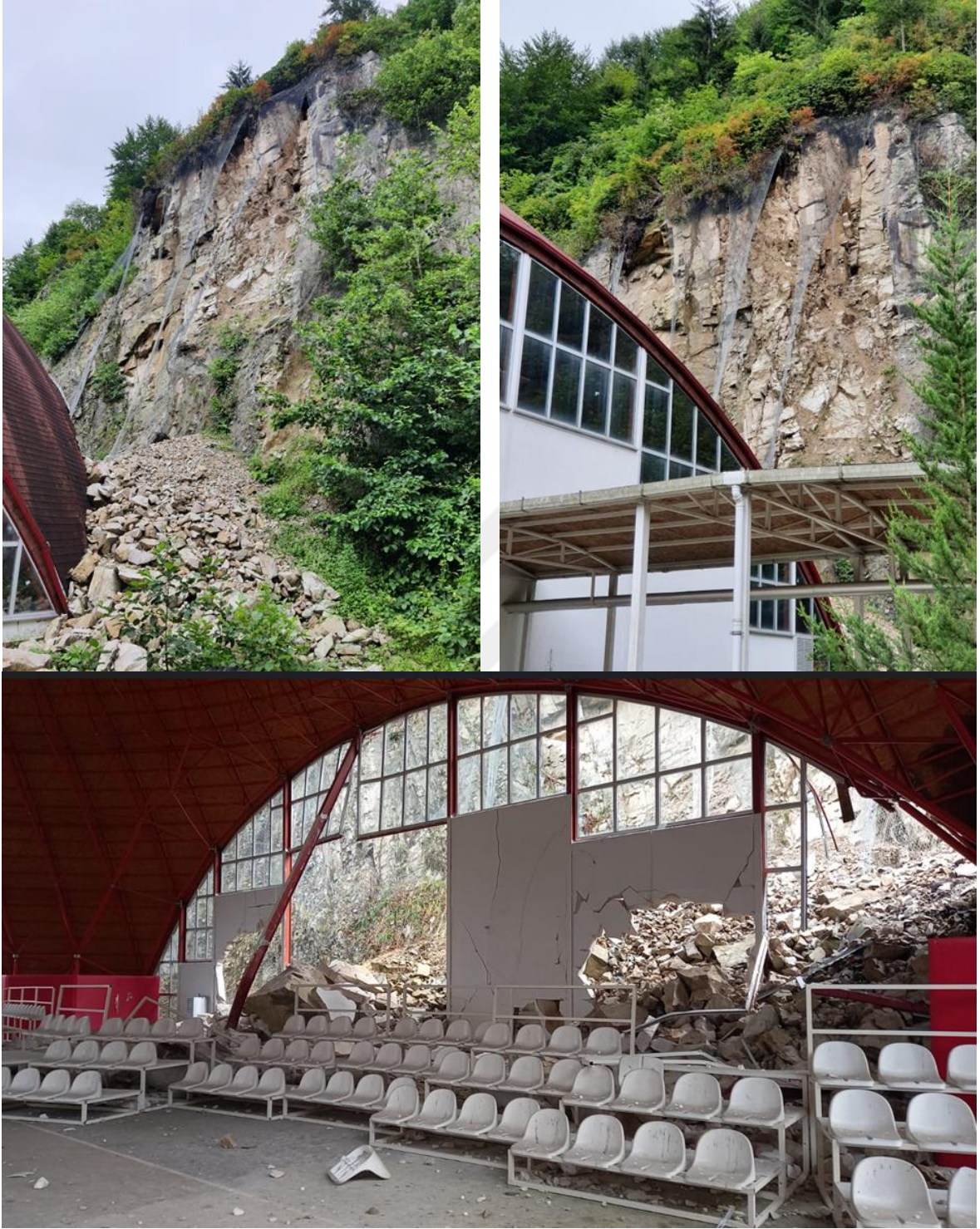
Şekil 14. Kaya düşme vakasının geliştiği kaya şevi (üst şekil) ve spor tesisin arka duvarını kırarak tesisin içine giren bloklar
