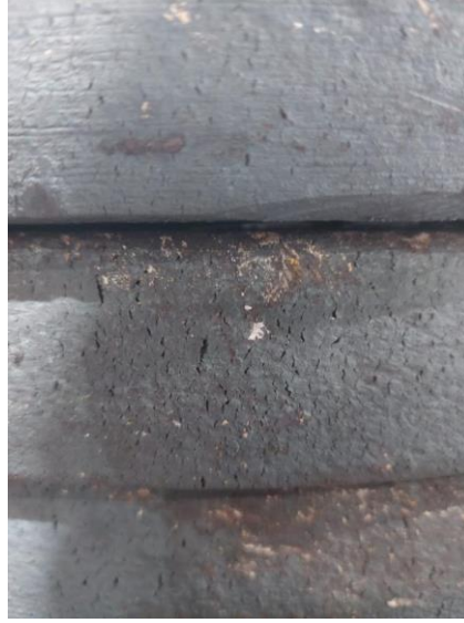
Şekil 1.1. Malzeme yüzeyinde oluşan çatlaklar
