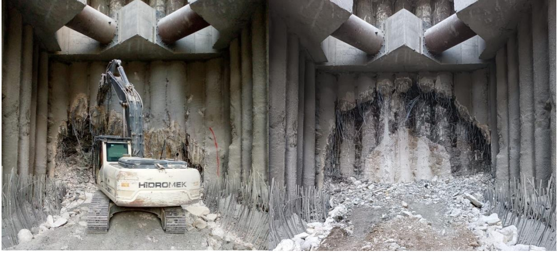
Şekil 4.35. Tünel çıkış kesimine denk gelen kazıkların kırımı.
