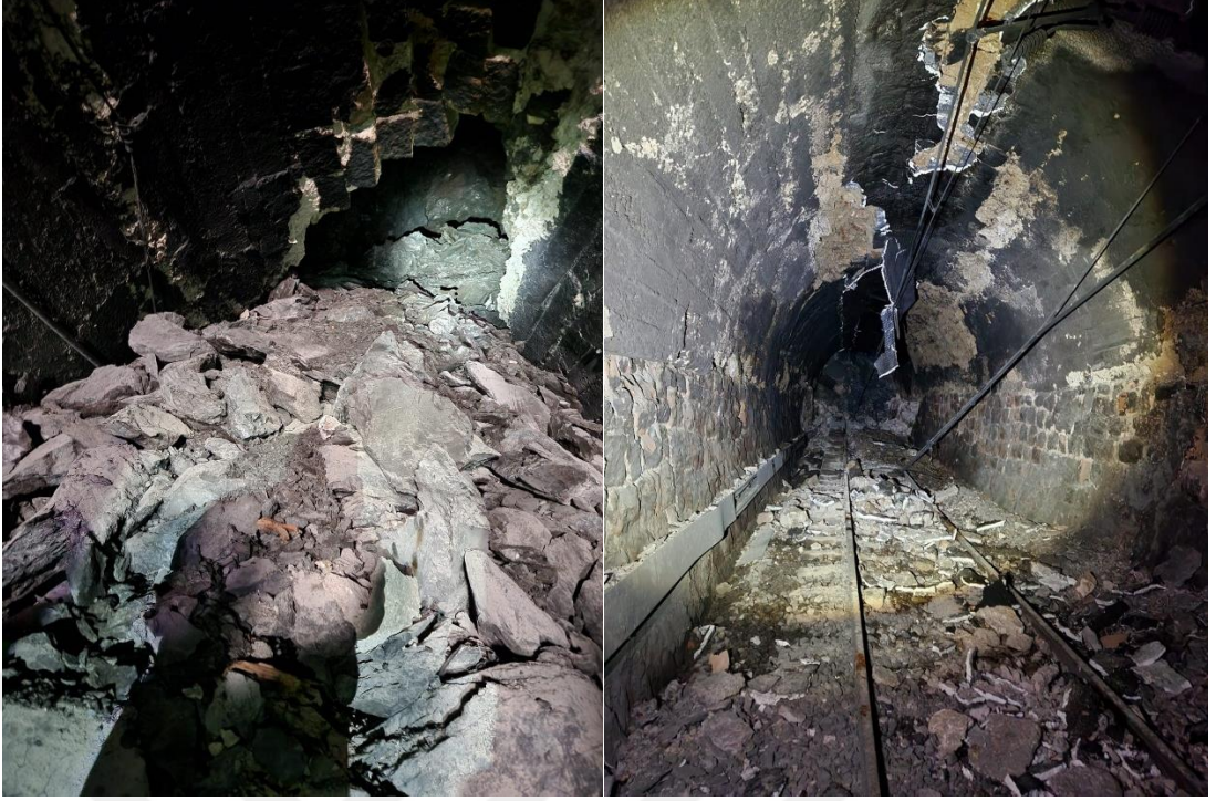
Şekil 3.2. T3 Tüneli oluşan göçük (giriş ve çıkış kesimlerinden).
