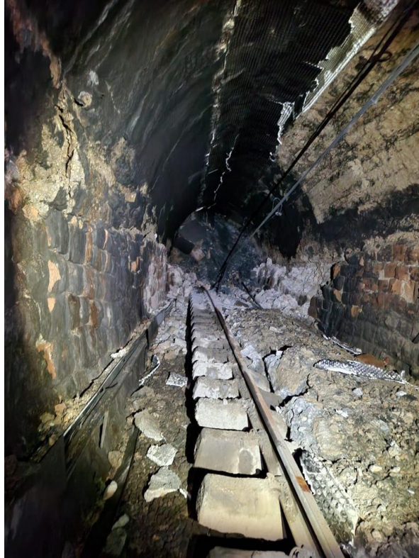
Şekil 3.3. T3 Tüneli çıkış kesiminde raylarda oluşan yükseklik farkı.
