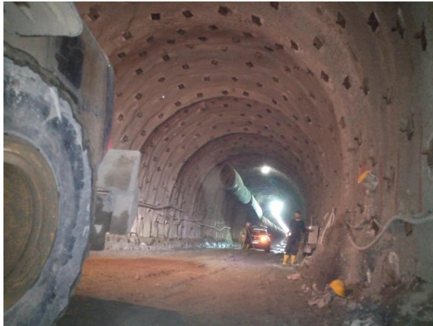
Şekil 4.61. T3 tüneli göçük meydana gelen-NATM ile açılmış kesim.
