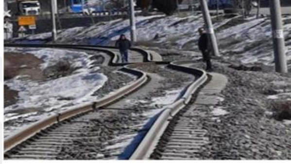
Şekil 11. Gölbaşı İlçesi Malatya Girişinde Demiryolunda Gözlenen Deformasyon
