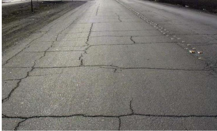
Şekil 1.5. Asfalt yolda termal çatlama örneği
