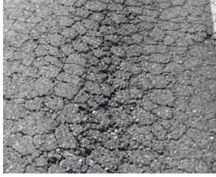
Şekil 1.4. Asfalt yolda yorulma çatlağı örneği (KGM, 2021)
