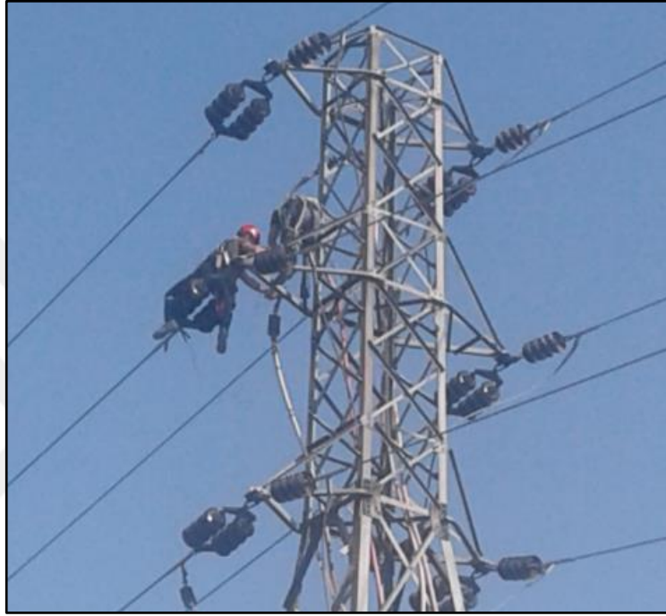
Şekil 2.28. İletkenlerin izolatörlere bağlanması
