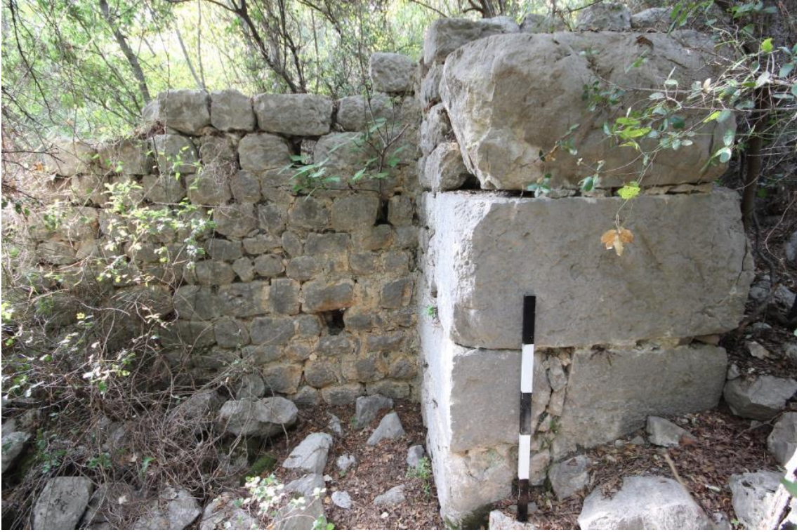
Fotoğraf 346. Mahyalar Köyü 2. Nolu Kilise Batı duvarı
