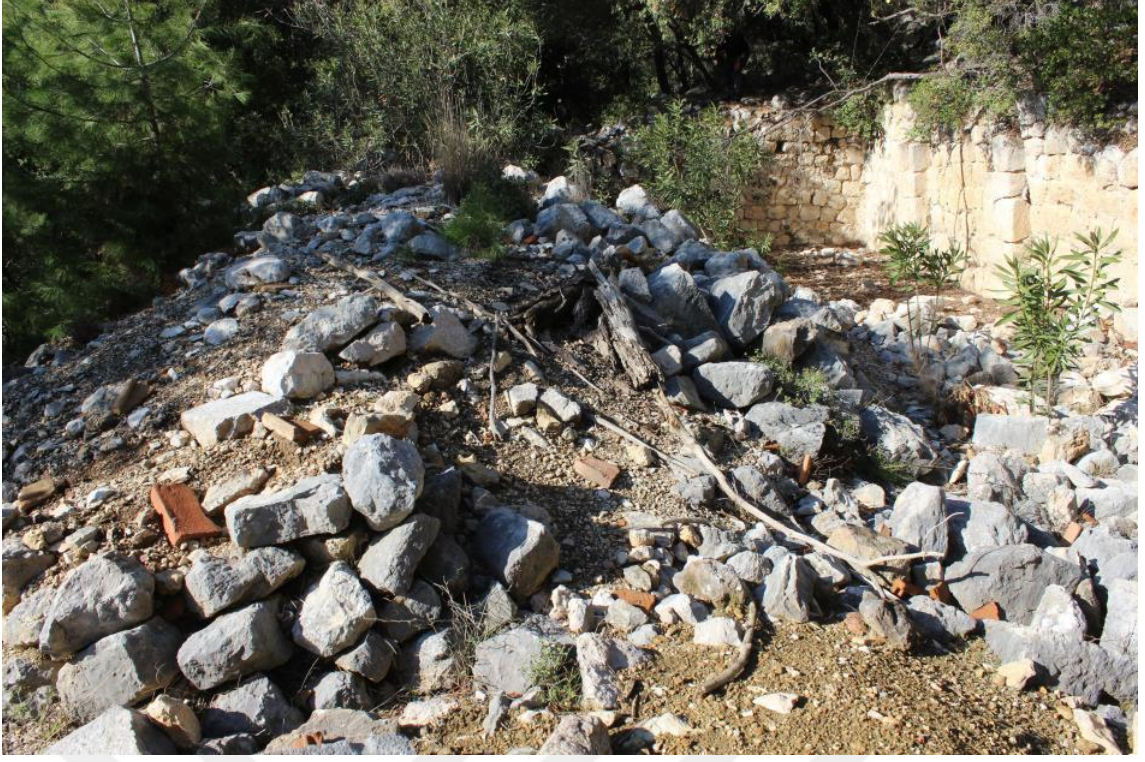
Fotoğraf 265 .Karasis Kilisesi güney duvarı yıkıntıları
