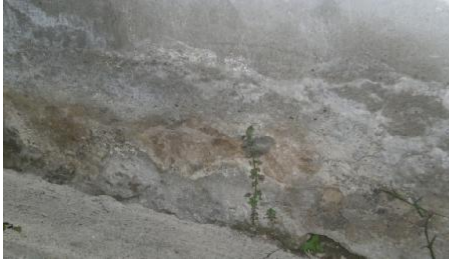
Şekil 3.10. Temelde Su ve Isı Yalıtımı Olmadığından Dolayı Nemden Zarar Görmüş Depo Temeli ve Duvarı
