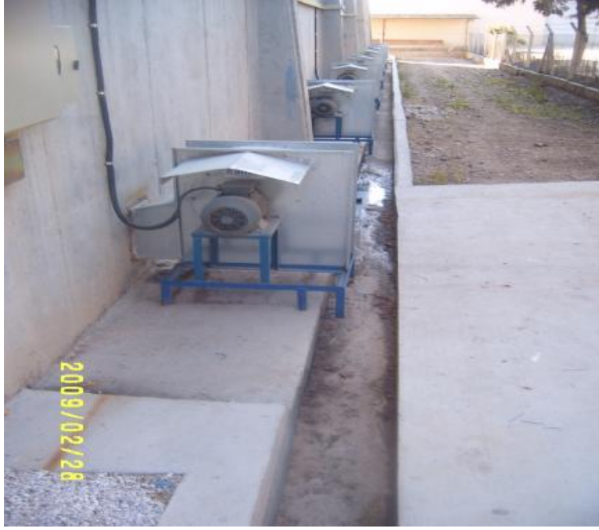
Şekil 3.9. 2.ve 3. Deponun Yerden Havalandırma Sistemi(Fanlar)
