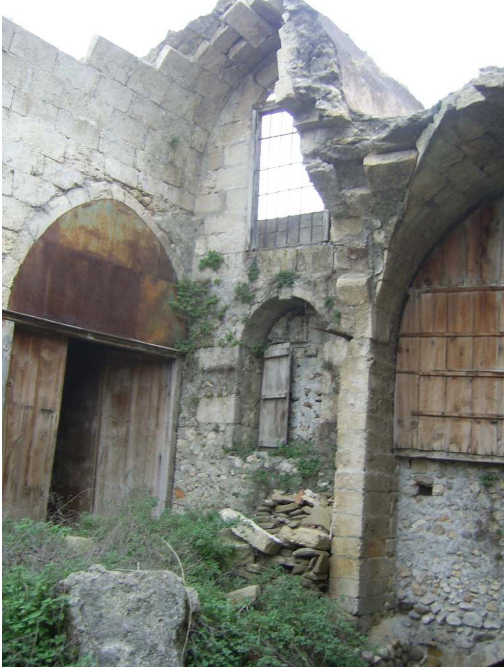
Ek 45: Tamamen yıkılmış olan arasta cepheleri
