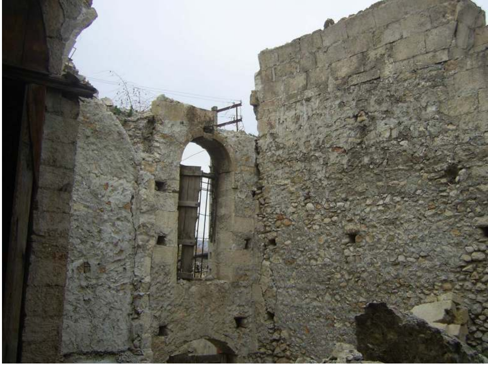
Ek 50: Tamamen yıkılmış olan arasta cepheleri
