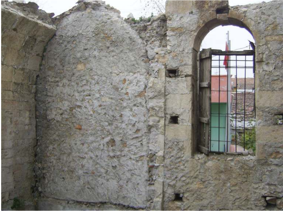
Ek 47: Tamamen yıkılmış olan arasta cepheleri
