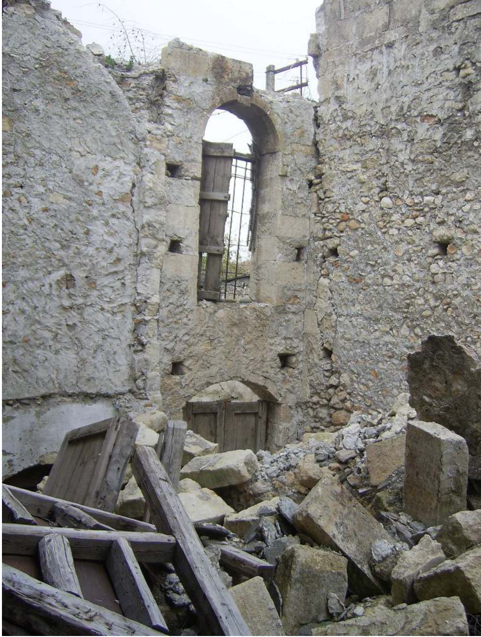
Ek 49: Tamamen yıkılmış olan arasta cepheleri
