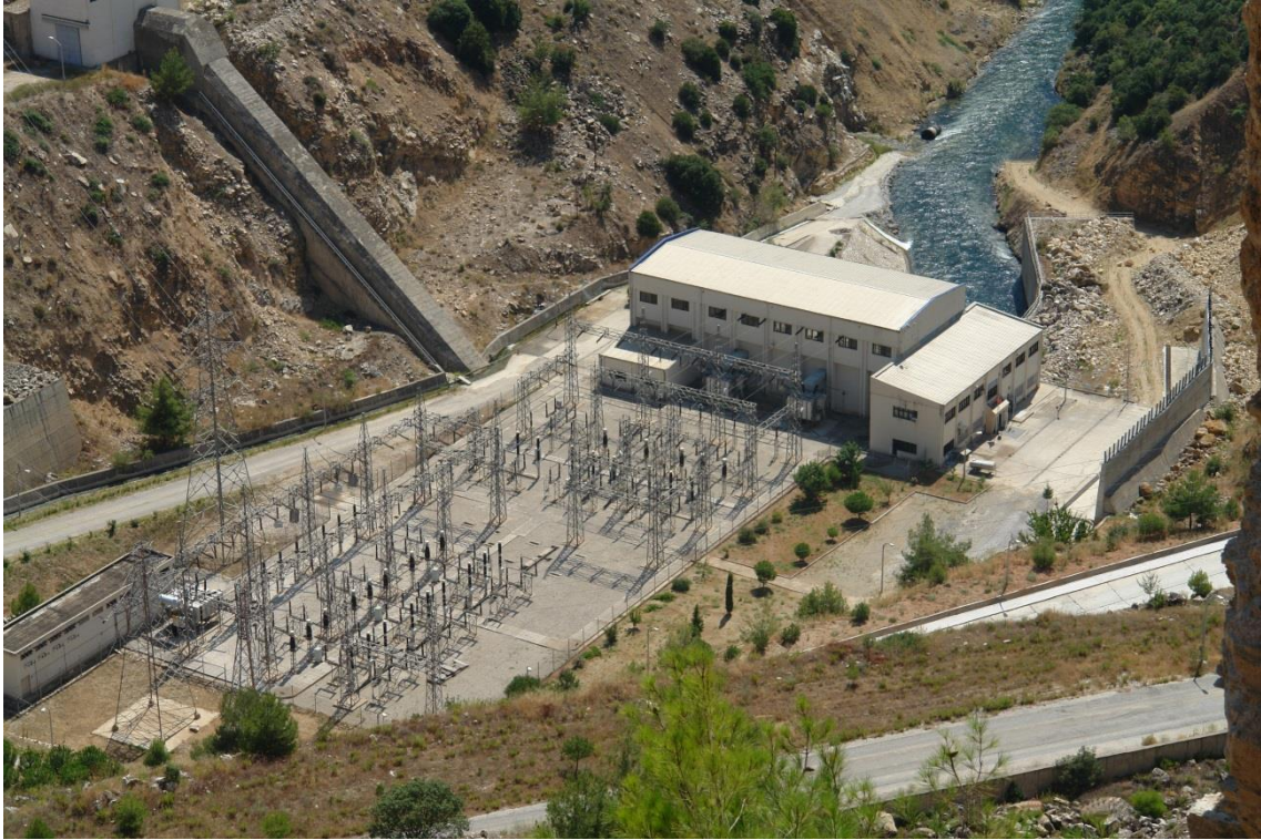
Resim 3.5. Adıgüzel HES santral binası ve şalt tesisi
