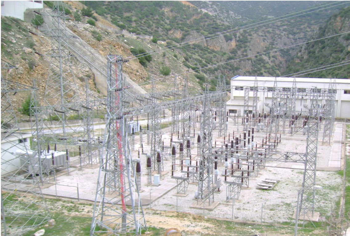
Resim 4.1. Adıgözel HES' in salt tesisi
