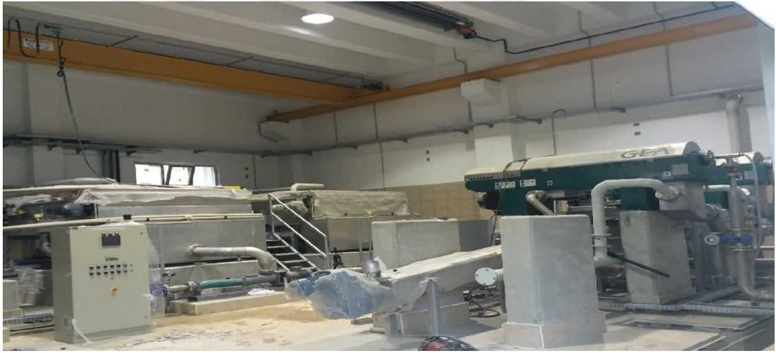
Şekil 5.15. Çamur yoğunlaştırma ve susuzlaştırma ünitesi
