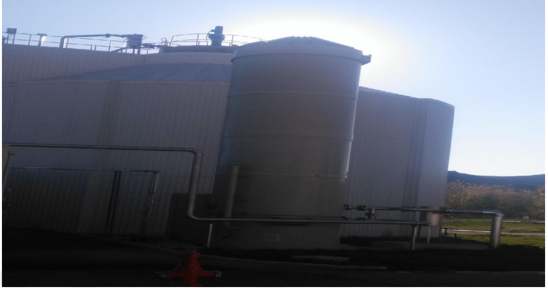
Şekil 5.10. Anaerobik çürütücü tankın dış görünümü
