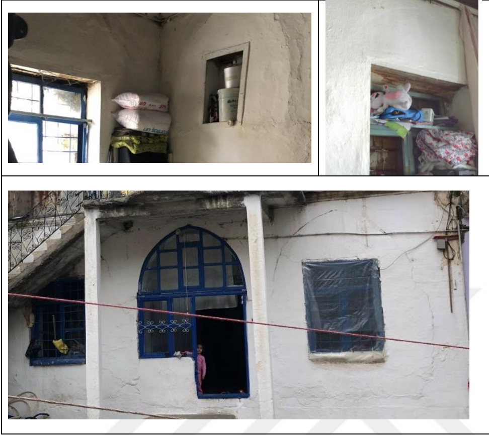
Şekil 4.126. Kapatılmış kemer izleri (a: Z03 Mekânı; b: Z02 Mekânı; c: Doğu Cephesi)
