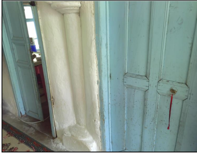
Şekil 4.113. Sütunda oluşan strüktürel bozulma
