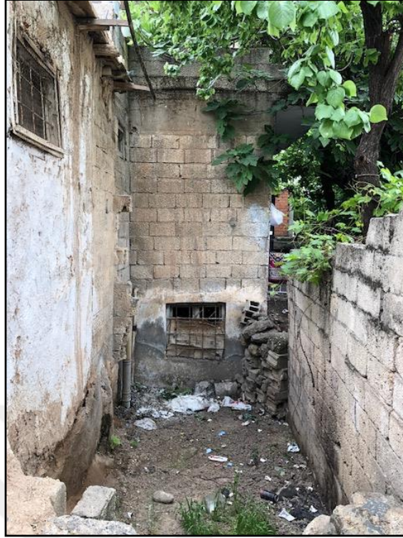
Şekil 4.60. Batı cephede bulunan avluya geçişin engellendiği sokak cephesi
