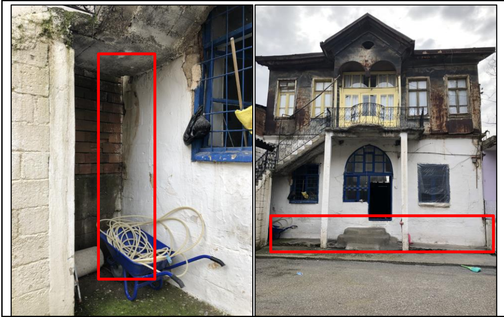
Şekil 4.115. Doğu cephesinde yağmur suyunun etkisiyle oluşmuş bozulmalar
