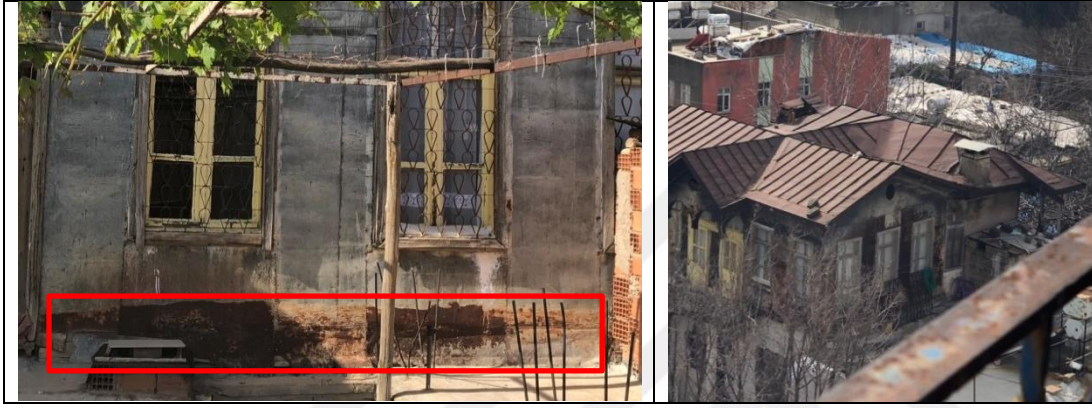
Şekil 4.117. Metal elemandaki bozulma (a: Kuzey cephede yer alan; b: Doğu ve güney cephelerde yer alan)
