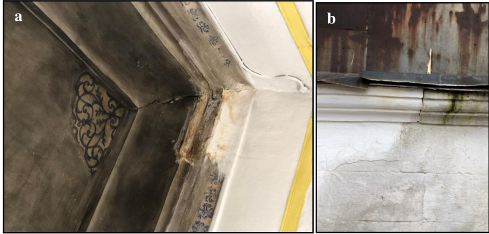
Şekil 4.116. a: 105 Numaralı mekân tavanında yağmur suyunun etkisiyle oluşmuş bozulma; b: Doğu cephesi kat silmesinde yağmur suyunun etkisiyle oluşmuş bozulma
