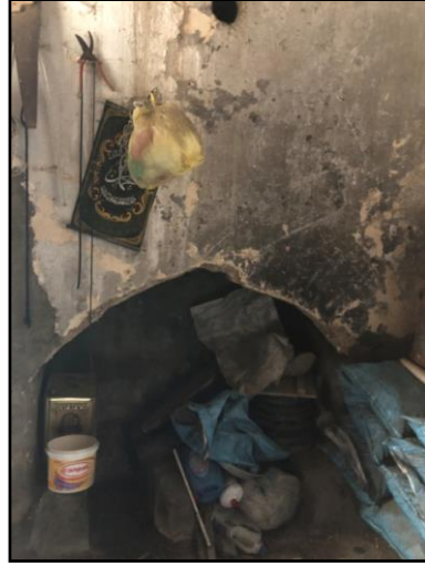
Şekil 4.39. Kadir İlik Evi zemin katta bulunan ocak
