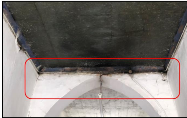
Şekil 4.118. Z01 Mekân tavanında metal elemandaki bozulma
