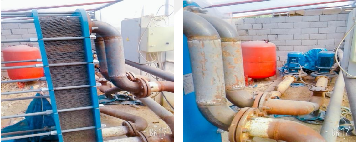
Şekil 2.9. İşletmelerde bulunan eşanjör
