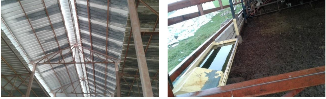
Şekil 4.36. Barınak yapı profillerindeki korozyon sorunu
