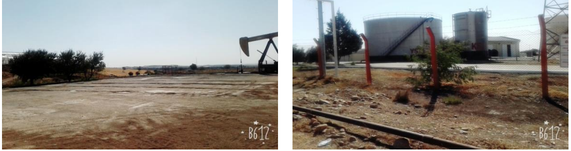
Şekil 2.8. Adıyaman ilinde seraların ısıtılmasında kullanılan TPAO tesisi
