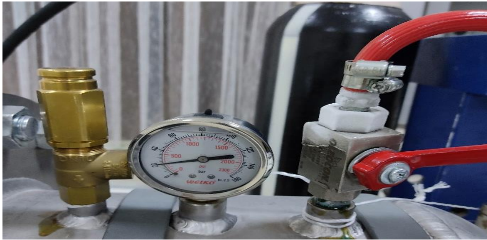
Şekil 3.25. Karbondioksitin drenaj edilmesi
