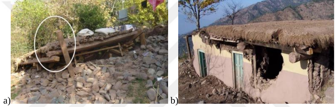
Şekil 3.13. Pakistan'da kırsal alanda afet sonrası konut hasarları (Mumtaz ve ark., 2008)
