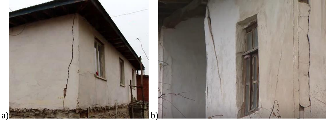
Şekil 4.11. İnandık Köyü'nde yapılarda gözlenen hasarlar (Aslan, 2019)
