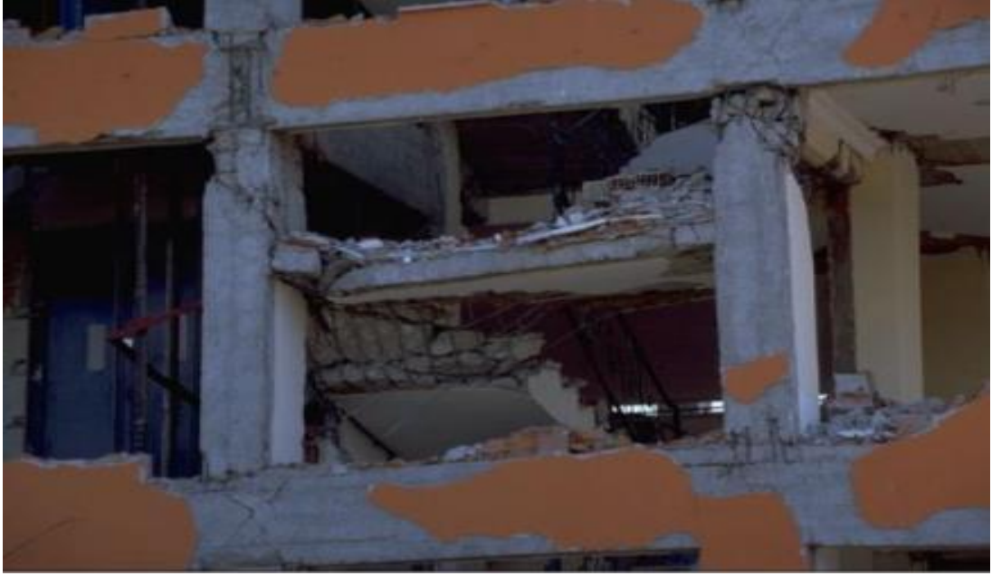
Şekil 36. 1999 Kocaeli Depremi merdiven sahanlığı kısa kolon etkisi (Robles, 1999).
