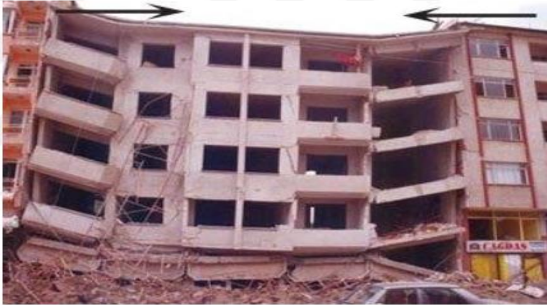
Şekil 35. 2011 Van Deprem'inde çekişleme ve yumuşak kat hasarı nedeniyle ağır hasar gören bir bina (Yılmaz, 2019).
