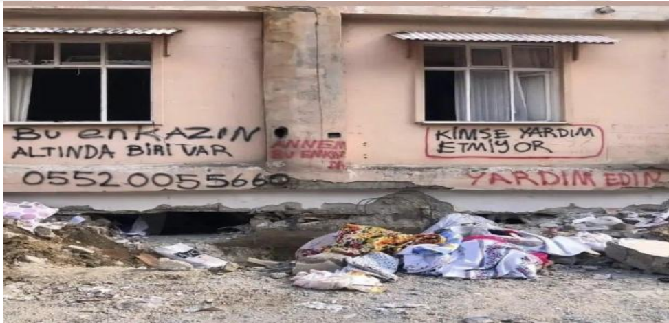
Şekil 13: Afet Dönemi Ağır Hasarlı Binaların Örnekleri (Yazar fotoğraf arşivi)
