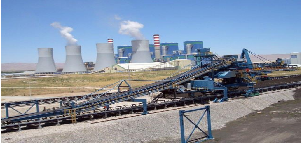
Şekil 5. 2: Kömür taşıma bantları [37].
