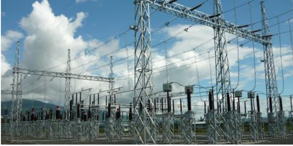
Şekil 5. 4: Şalt sahası görünümü [39].
