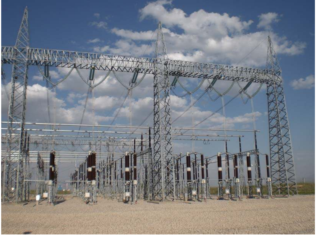
Resim 9: Afşin Elbistan Çobanbeyli Şalt Sahası
