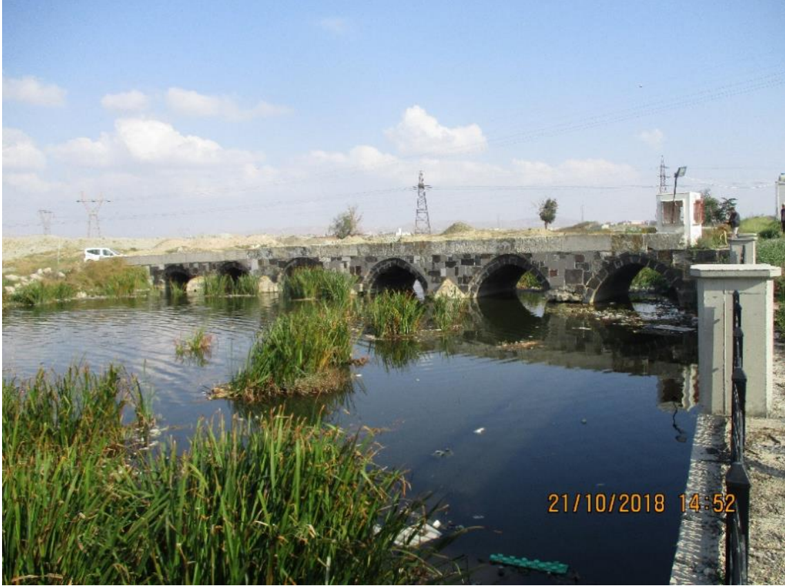
Resim 4.1 Altıgöz Köprüsü Kuzey cephesi yıkılmış mahmuz ve düşen kesme taşların görünümü.
