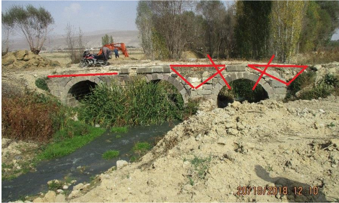
Resim 4.71 Balmahmut Köprüsü restore edilen taşlar ve mevcut hasar durumu.
