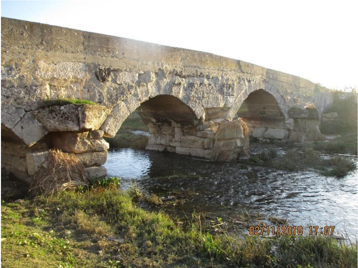
Resim 4.9 Kurşunlu Köprüsü zarar gören mahmuzların görünümü.
