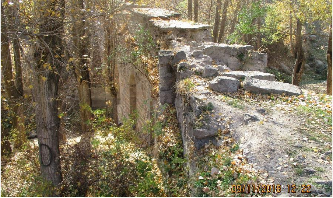
Resim 4.13 Kadınana Köprüsü zarar görmüş döşeme görünümü.
