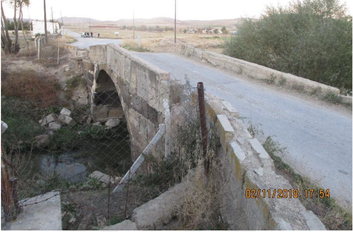
Resim 4.6 Kanlı Gölet Köprüsü dökülen korkuluk taşları ve köprüye yapılan ankrajın görünümü.
