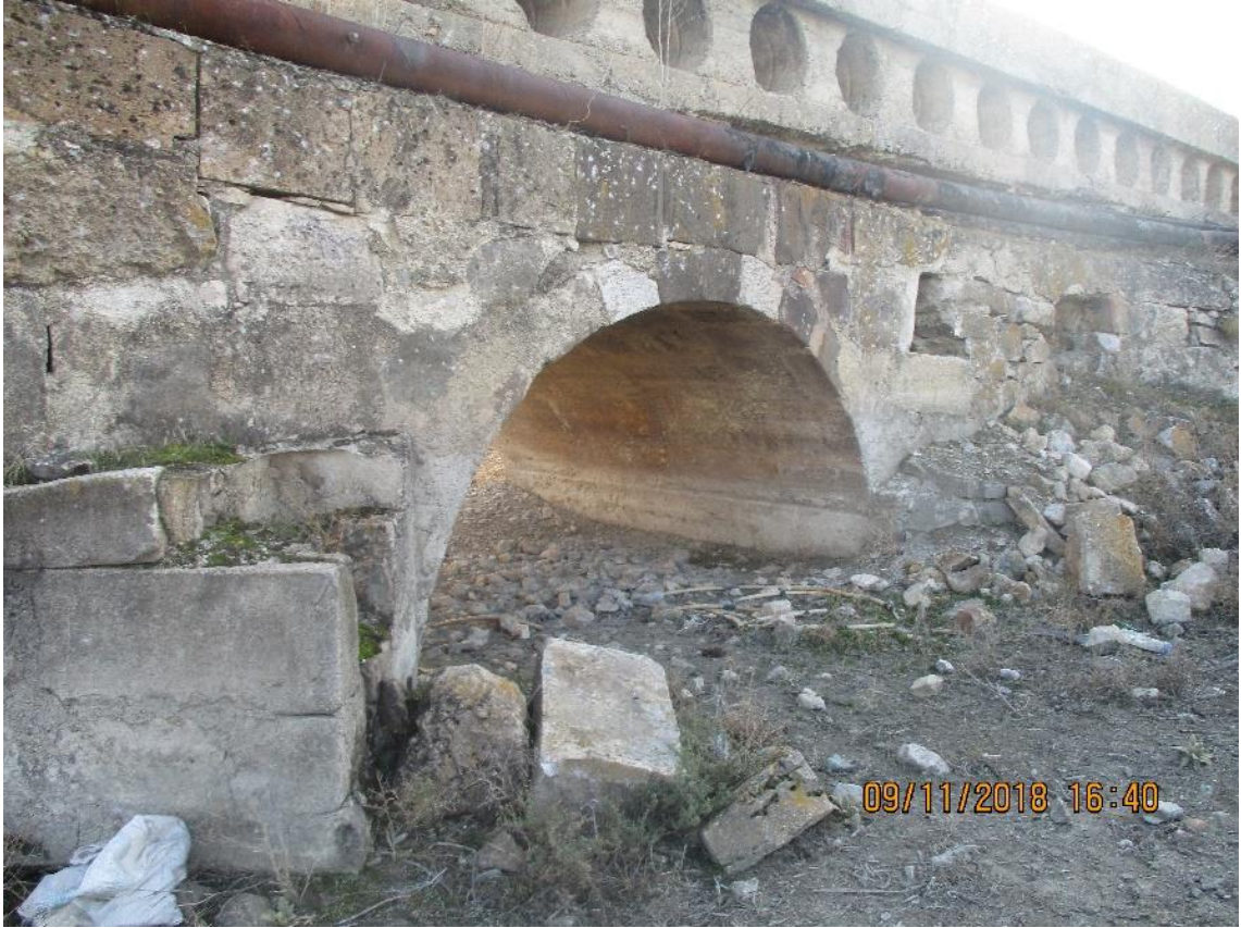
Resim 4.63 Taş Köprüsü deformasyona uğramış mahmuzların ve taşların görünümü.
