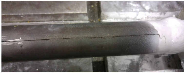
Şekil 6.25 : Boru kaynak dikişi boyunca hasara uğrayan 26MnB5.
