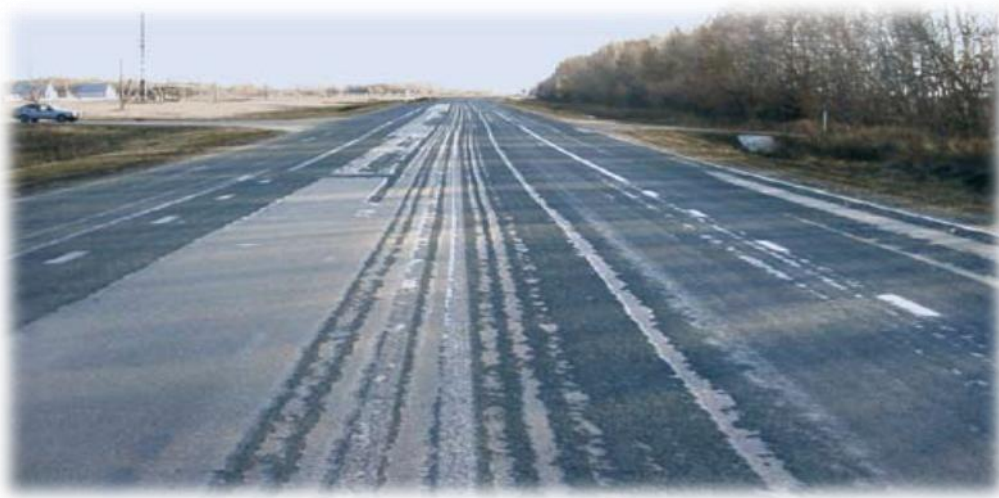
Resim 2.3. Düşük adezyona bağlı yüzeyden agregat kopması
