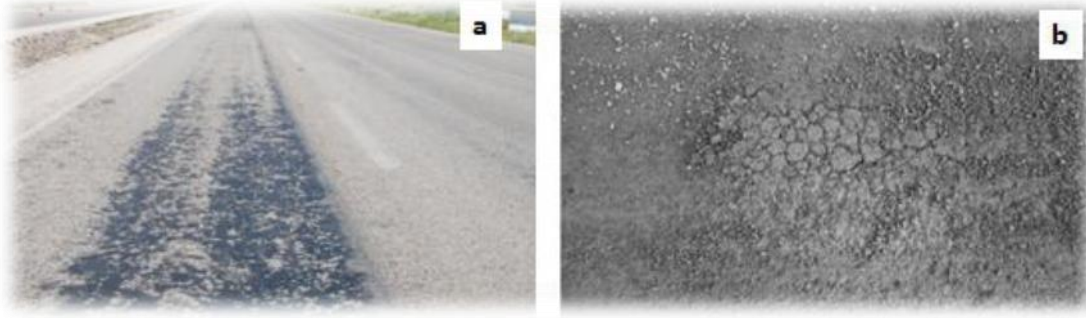
Resim 2.2. Bir sathi kaplama yüzeyinde adezyon yetersizliği nedeniyle meydana gelen agregat kopmaları (a) ve yüzeyde meydana gelen ayrışmalar(b).
