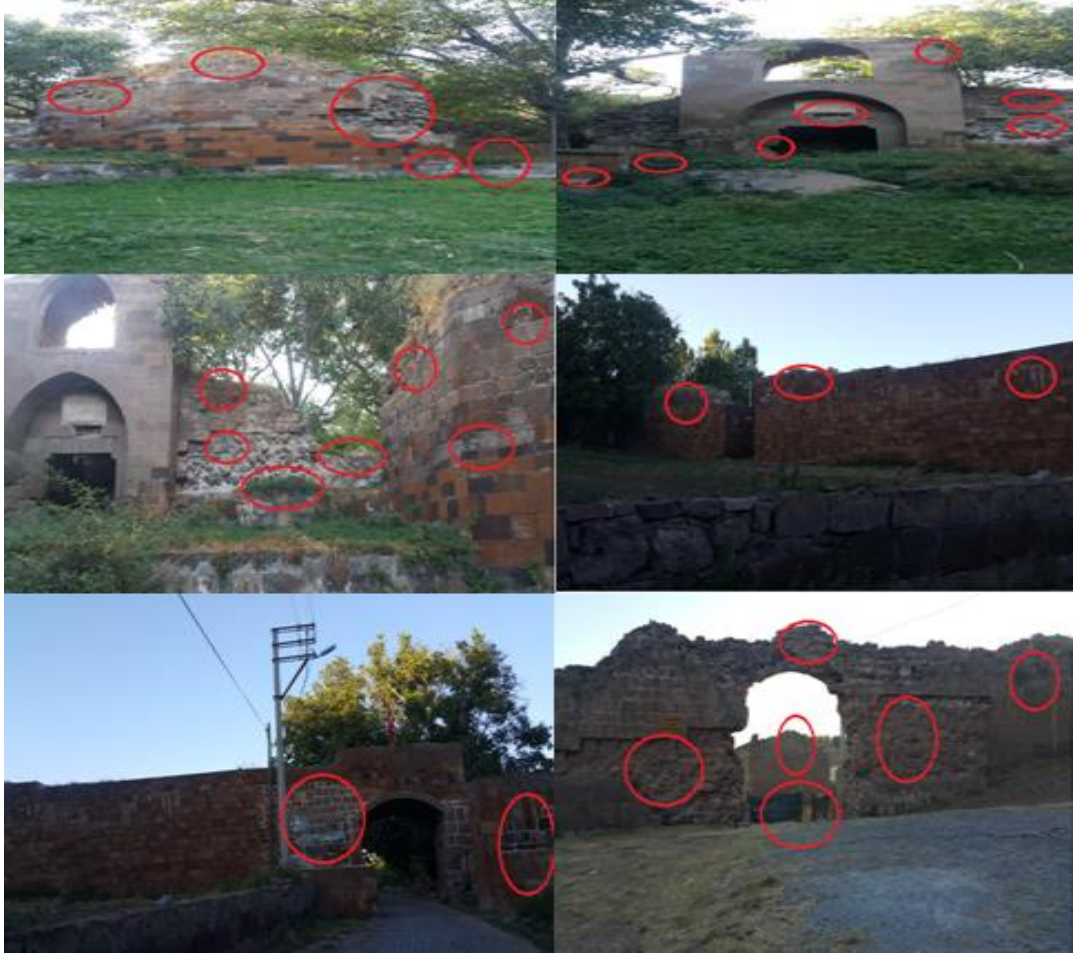
Şekil 4.4. Sahil Kalesinde gözlemlenen hasarlar
