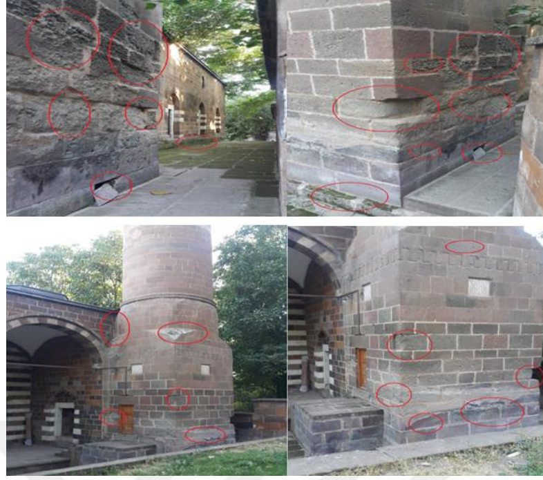
Şekil 4.10. İskender Paşa Camiinde gözlemlenen hasarlar
