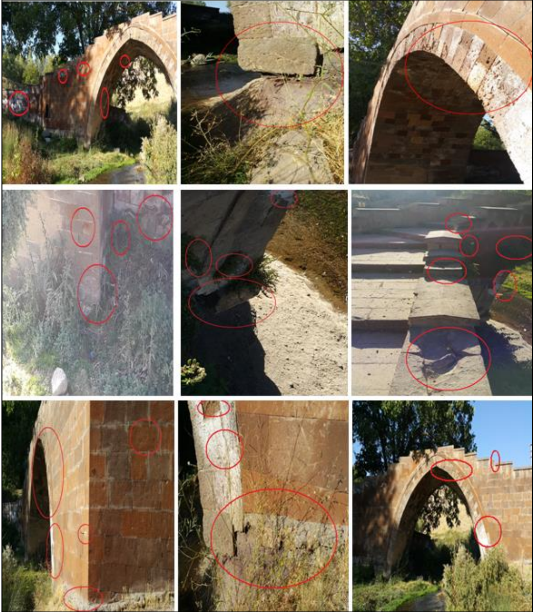
Şekil 4.3. Emir Bayındır Köprüsünde gözlemlenen hasarlar
