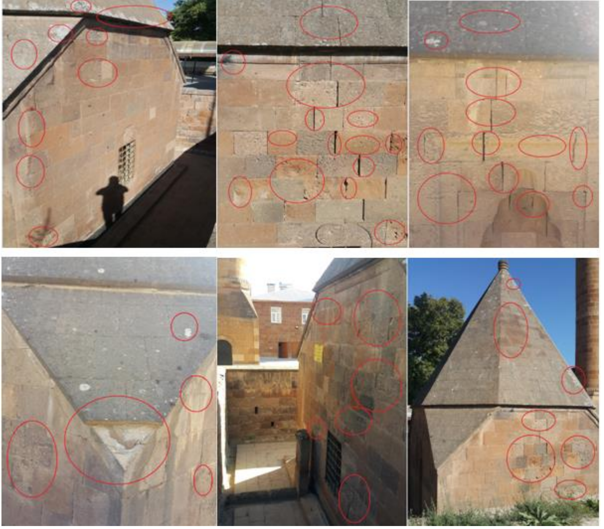
Şekil 4.15. Mirza Bey Kümbetinde gözlemlenen hasarlar
