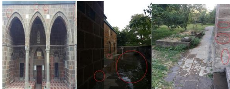
Şekil 4.11. Kadı Mahmut Camiinde gözlemlenen hasarlar
