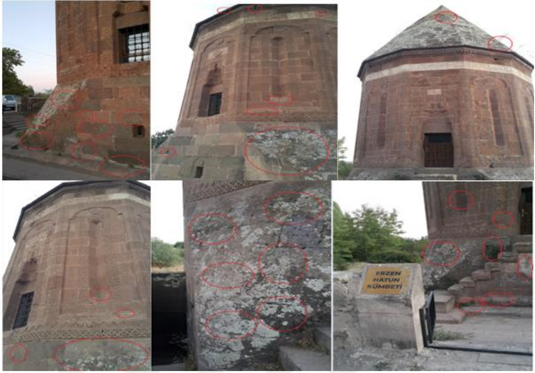
Şekil 4.16. Erzen Hatun Kumbetinde gözlemlenen hasarlar
