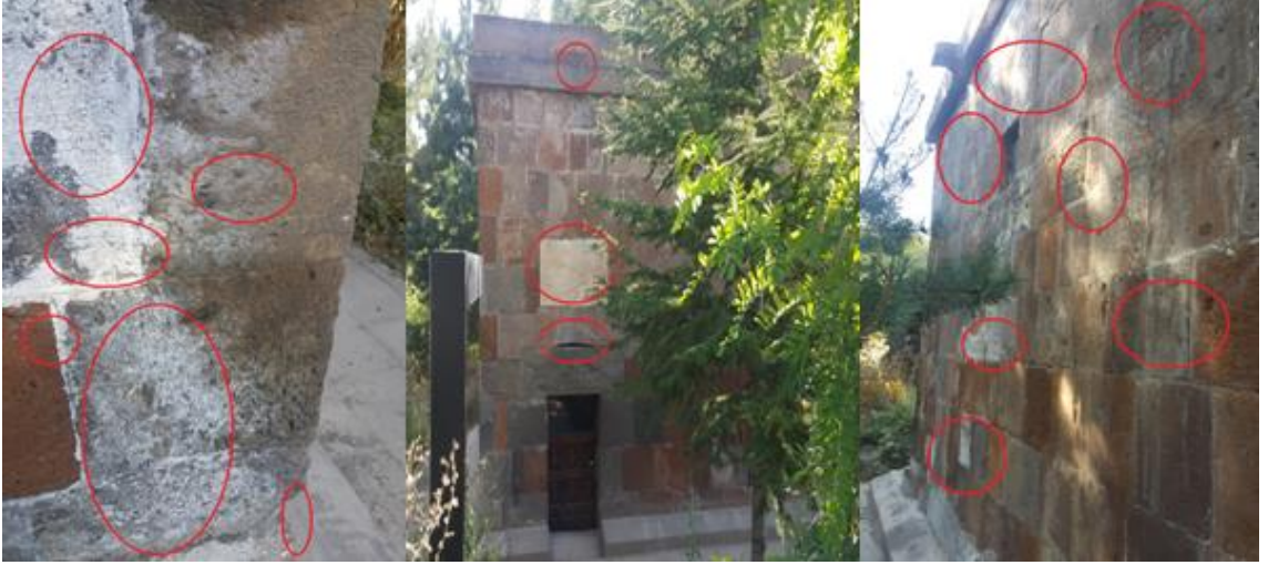
Şekil 4.25. Dede Maksut Türbesinde gözlemlenen hasarlar
