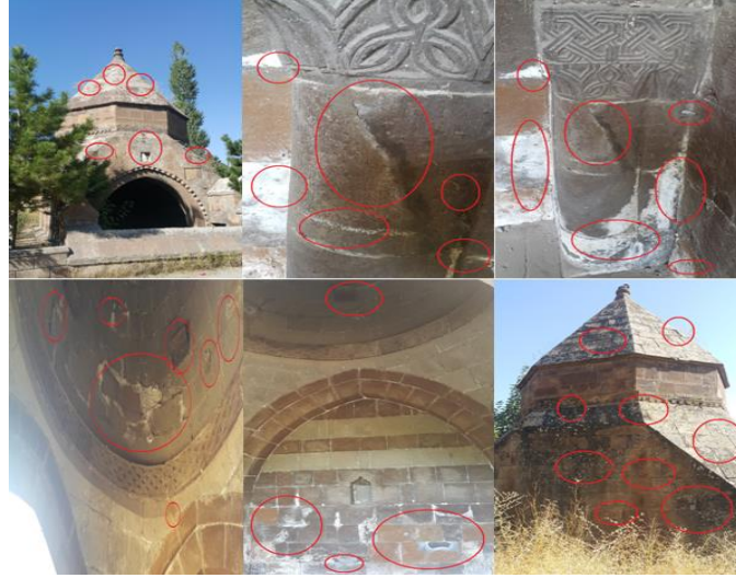
Şekil 4.29. Emir Ali Türbesinde gözlemlenen hasarlar
