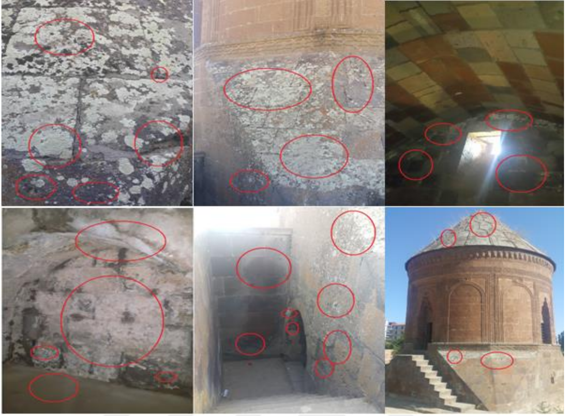
Şekil 4.23. Bugatay Aka - Şirin Hatun Kümbetinde gözlemlenen hasarlar
