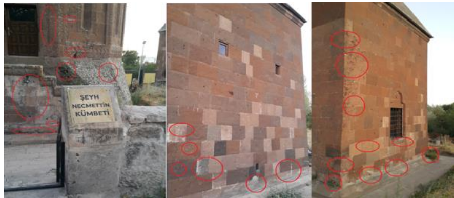
Şekil 4.28. Şeyh Necmettin Türbesinde gözlemlenen hasarlar
