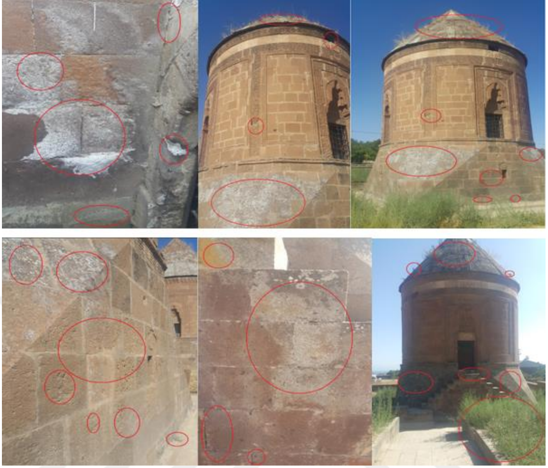
Şekil 4.13. Hüseyin Timur Kümbetinde gözlemlenen hasarlar
