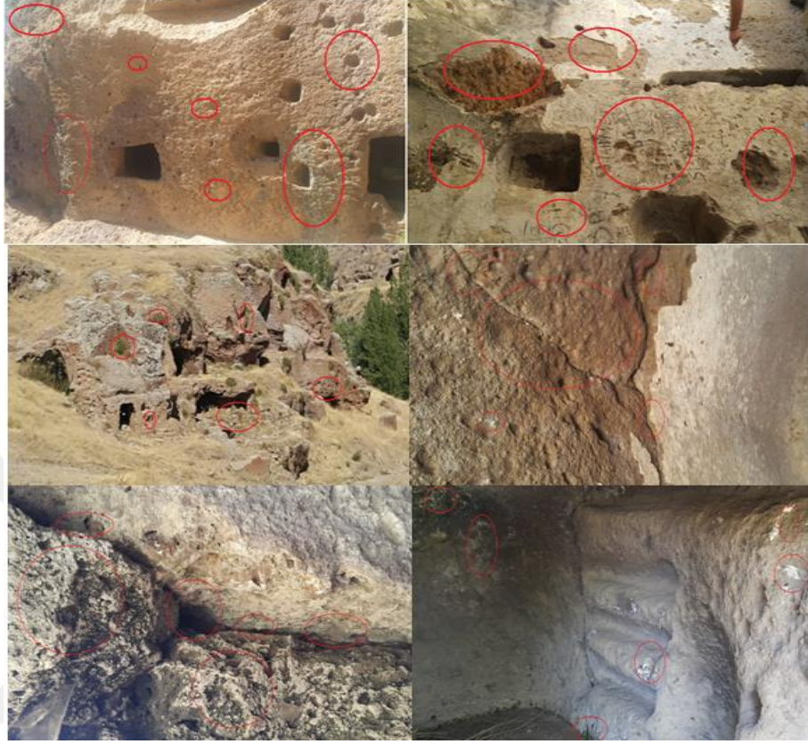
Şekil 4.8. Madavans mağara evlerinde gözlemlenen hasarlar
