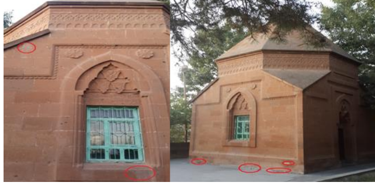
Şekil 4.27. Abdurrahman Gazi Türbesinde gözlemlenen hasarlar
