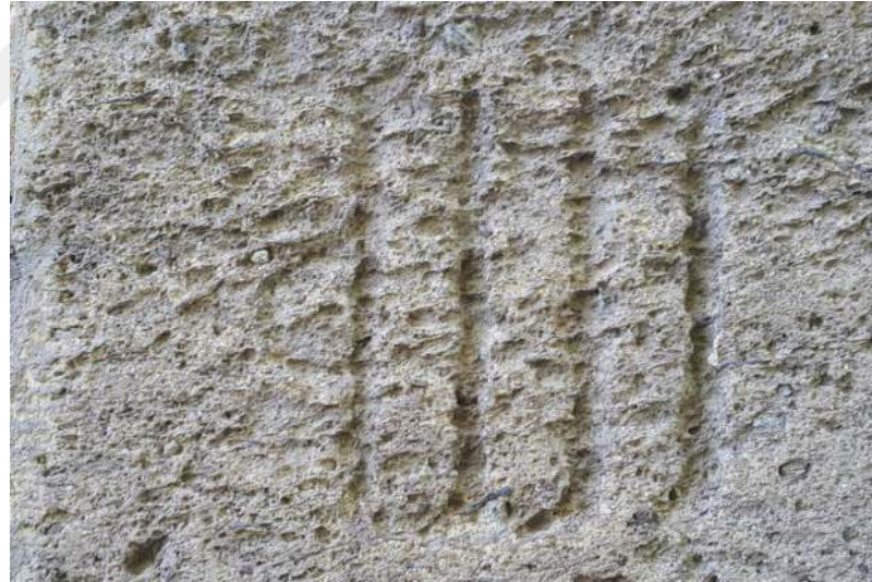
Şekil 4.26. Suyun taşı oyması sonucu oluşan hasar
