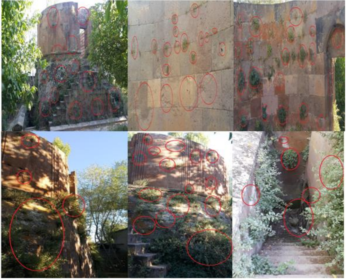
Şekil 4.21. Alimoğlu Hurşit Kümbetinde gözlemlenen hasarlar
