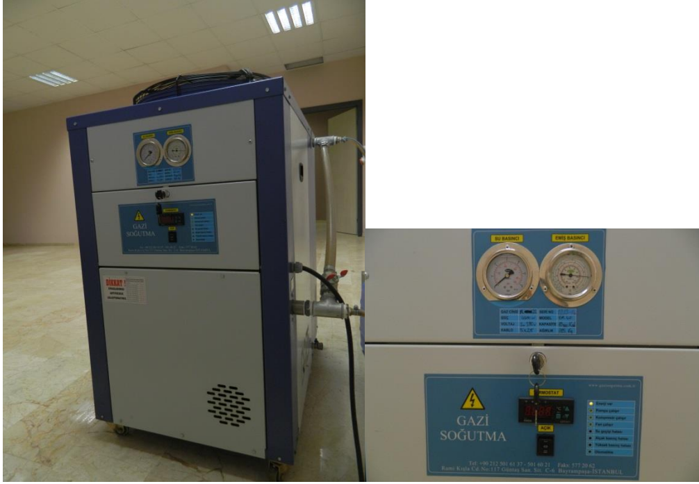
Şekil 5.9: Soğutucu ünite ve elektronik kontrol paneli
