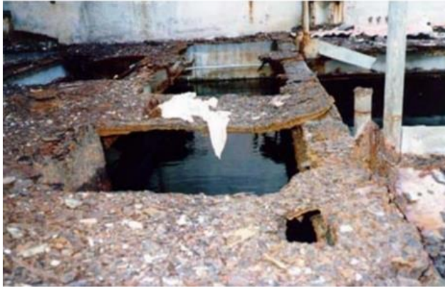
Resim 2. 1. Üniorm korozyon örneği
