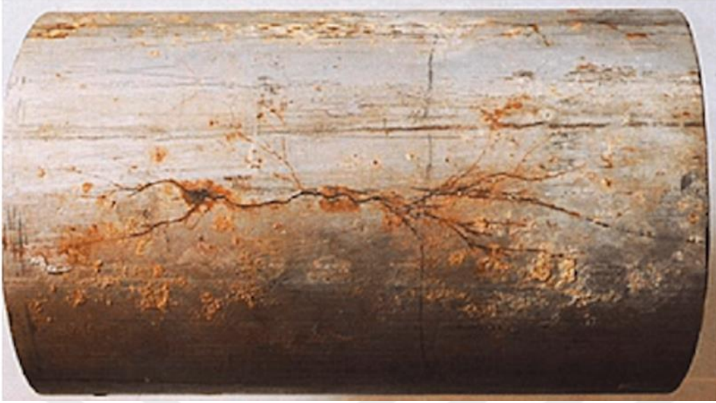
Resim 2. 4. Gerilmeli korozyon örneđi
