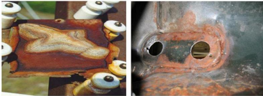
Resim 2. 3. Aralık korozyon örneği
