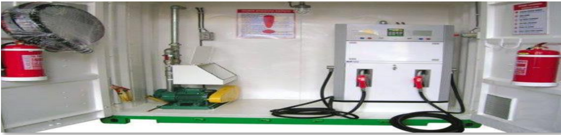
Resim 2.7. Mobil olarak tesis edilmiş akaryakıt istasyonu örneği
