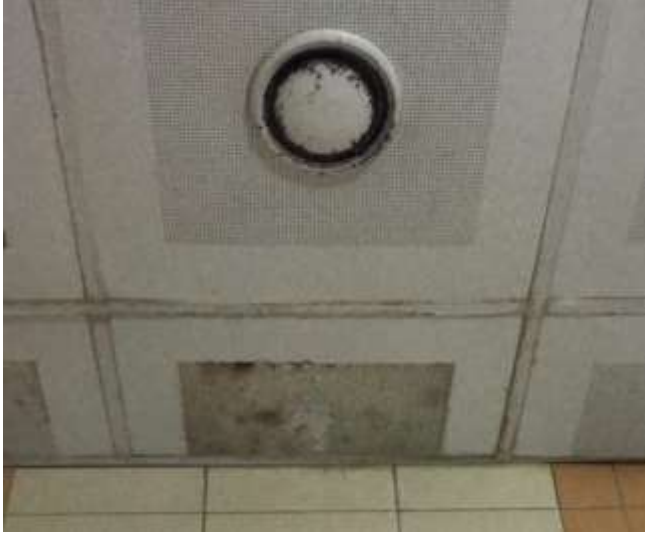
řekil 4.188. Mühendislik Fakóltesi 1. kat tuvaletinde tuvalet rezervuarlarına baėlanan su borularından oluřan sızıntılar
