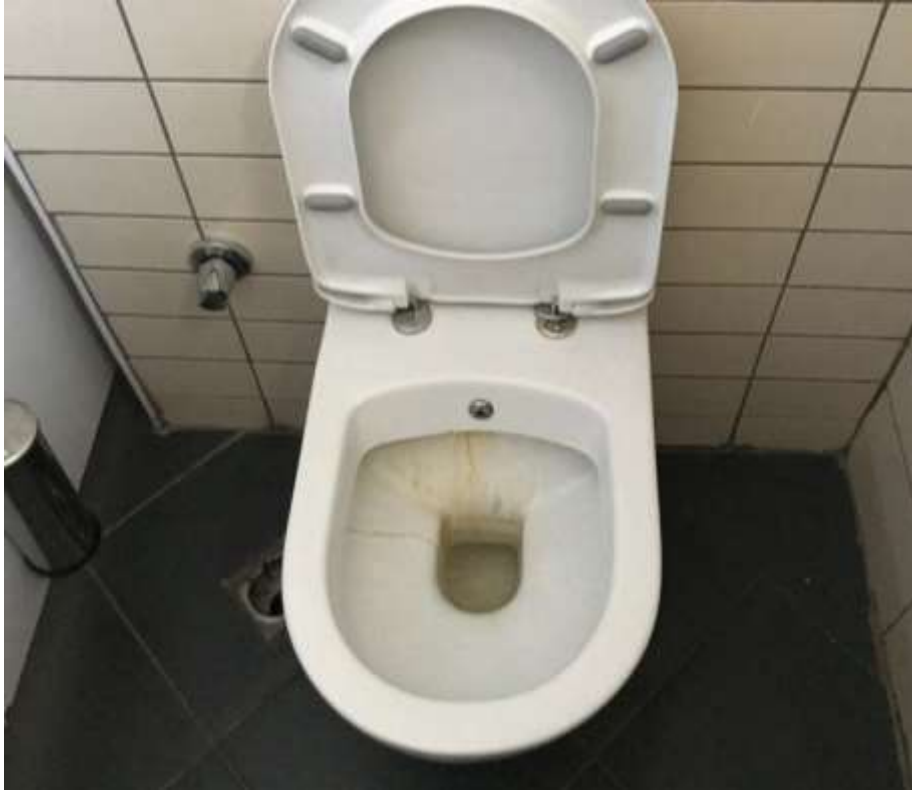
Şekil 4.203. Mühendislik Fakültesi b blok 2. kat gıda mühendisliği personeli tuvaletinde takılı kalan rezervuar
