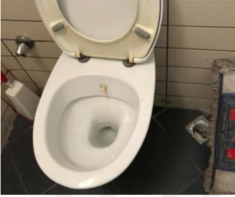
Şekil 4.204. Mühendislik Fakültesi mescidde oluşan sızıntı
