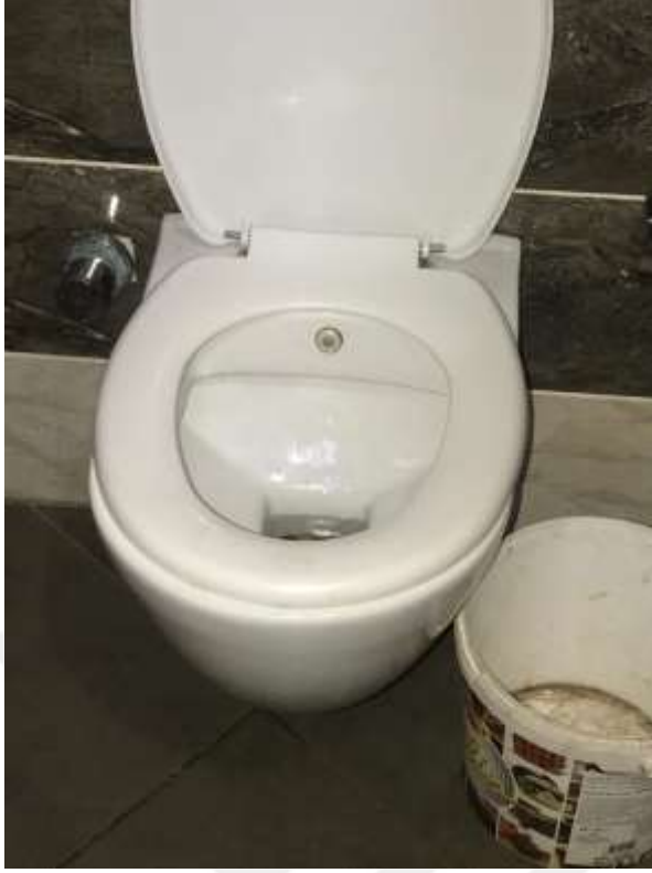
Şekil 4.170. 22.01.2020 tarihinde Olbia bayan tuvaletinde yapılan incelemede sürekli su sızıntısına neden olan arızalı tuvaletin tespit edilmesi
