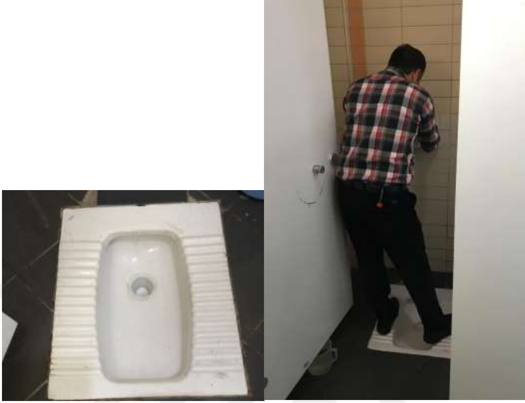
Şekil 4.192. Mühendislik Fakültesi 1. kat tuvaletinde tespit edilen arızalı tuvalet ve tamirati
