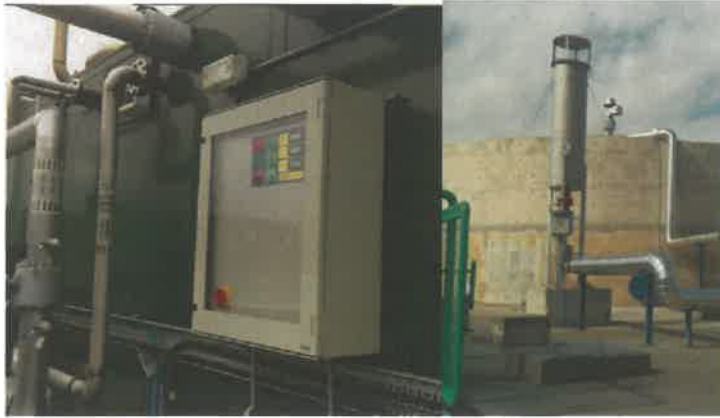
Şekil 4.51. Biyogaz tesisi gaz kontrol hatları.
