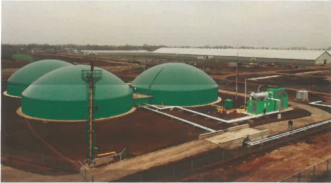
Şekil 4.46. Örnek bir biyogaz tesisi (Enerjiportali, 2018)
