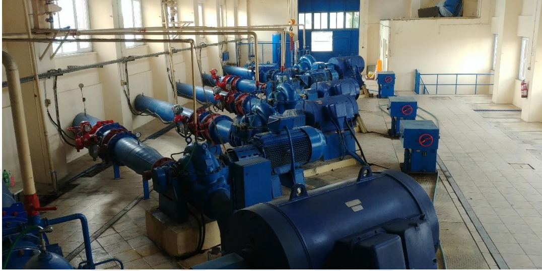
Şekil 3.5. Göksu pompa istasyonu pompa dairesi
