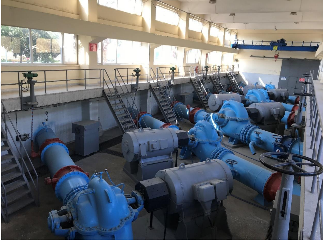
Şekil 3.11. Yahşelli pompa istasyonu
