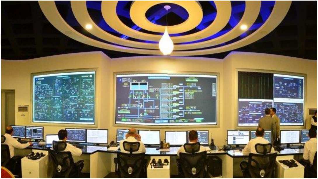
Şekil 3.10. İZSU scada sistemi kontrol odası
