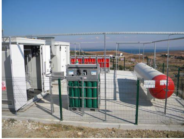
Şekil 3.6: Çanakkale-Bozcaada hidrojen enerjisi tesisi
