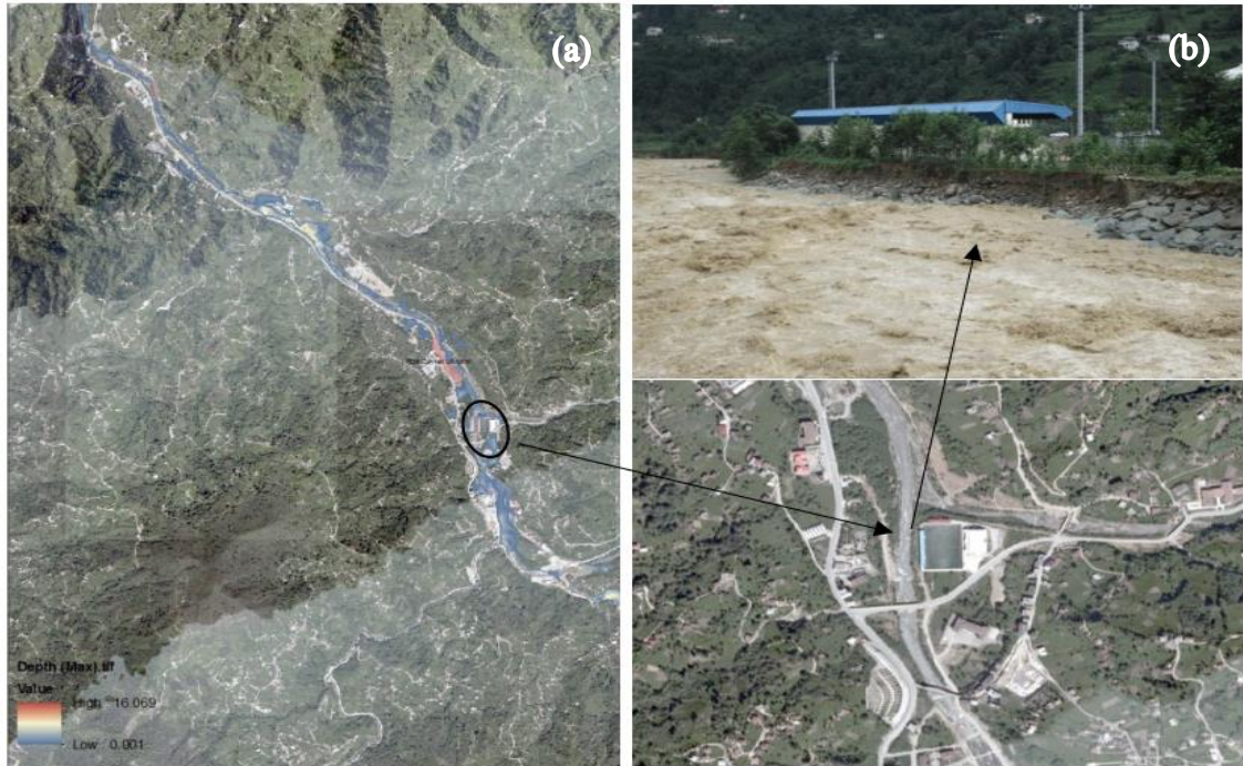
Şekil 18. a. Taşkın modelleme sonucu belirlenen taşkın tehlikesi altında olan alanlar, b. Güneysu İlçesi futbol sahasının bulunduğu alanda sağ sahilde bulunan zarar görmüş taş istinat duvarı.
