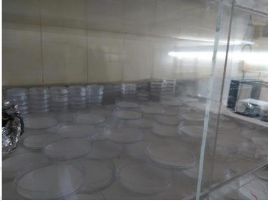
Şekil 3.4. ODTÜ Çevre Mühendisliği temiz oda ve filtreler.
