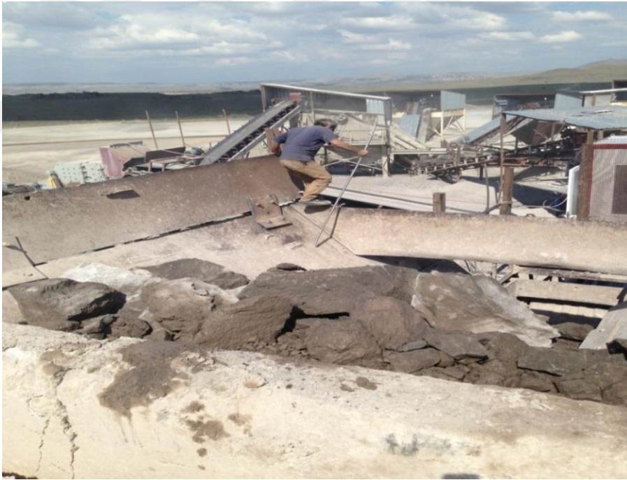
Şekil 3.12: Kırıcı ağız kontrolü (yanlış uygulama).
