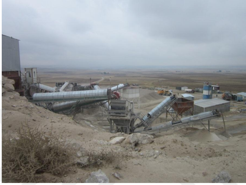
Şekil 3.5: Taş ocakları agrega üretim tesisleri genel görünüşü.
