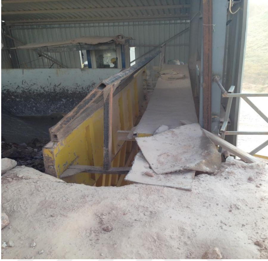
Şekil 3.26: Geçiş yolları ve korumalıklar (yanlış uygulama).
