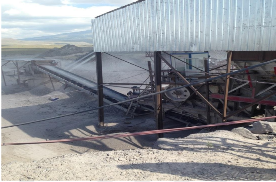
Şekil 3.23: Üzeri açık bant konveyör (yanlış uygulama).
