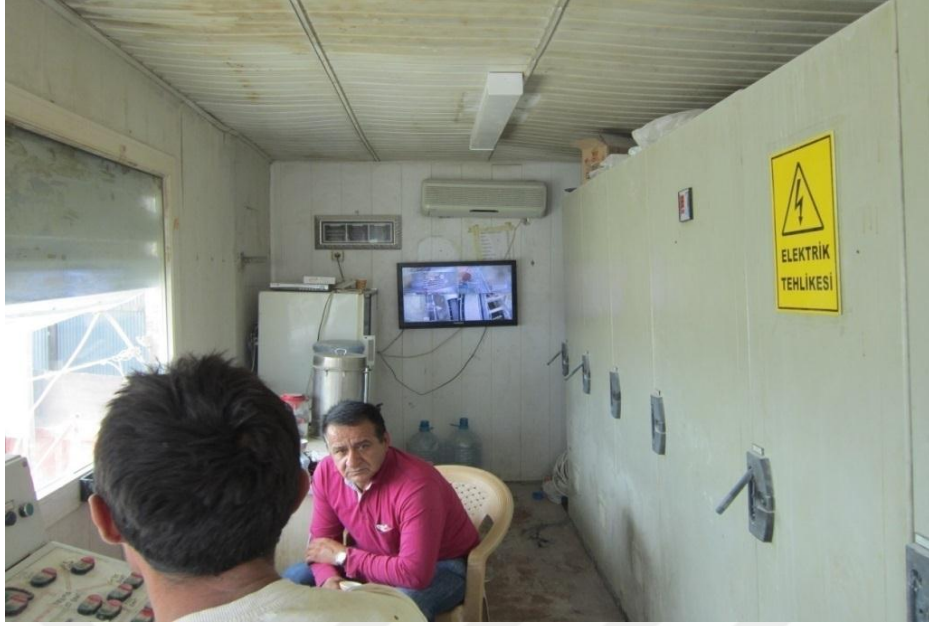
Şekil 3.27: Elektrik dağıtım ve kontrol paneli (doğru uygulama).
