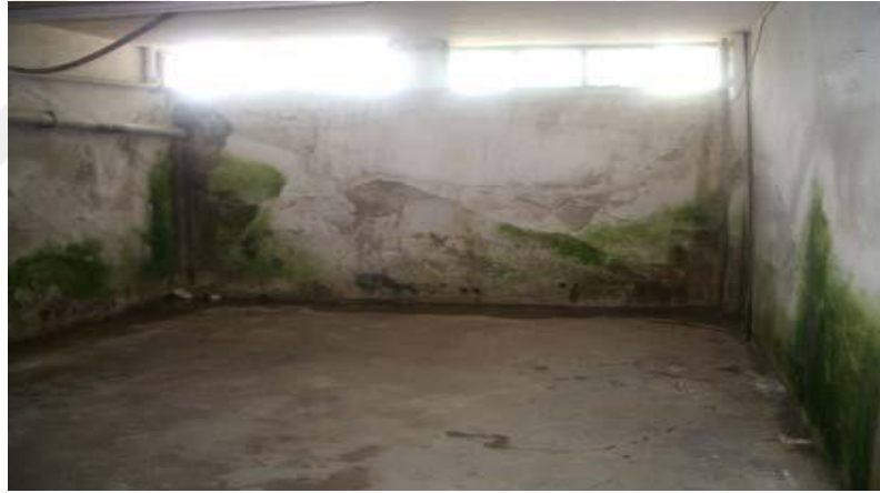
Şekil 4.33. Yeraltı suyunun bina bodrum katı betonarme duvarlarına verdiği hasar (Şimşek, 2005).
