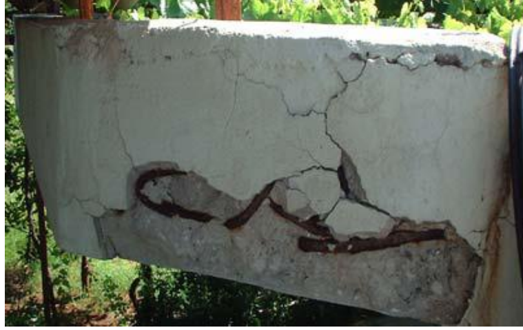
Şekil 4.34. Çevresel faktörlerle korozyona uğramış çelik donatı (Şimşek, 2005).
