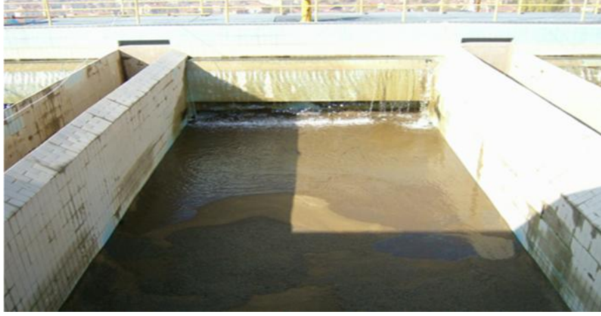
Şekil 6.8: Kılıçaslan arıtma tesisi hızlı kum filtreleri.
