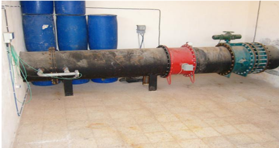
Şekil 6.4: Kılıçaslan içme ve kullanma suyu arıtma tesisisi girişi.
