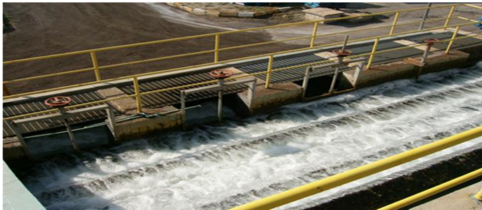
Şekil 6.6: Kılıçaslan arıtma tesisi kaskat havalandırma yapısı.
