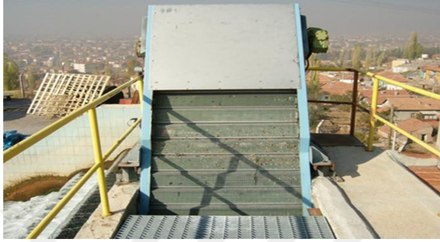
Şekil 6.5: Kılıçaslan içme ve kullanma suyu arıtma tesisi mekanik temizlemeli ince ızgara.
