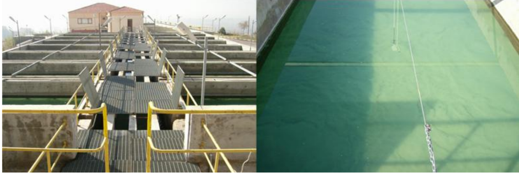
Şekil 6.7: Kılıçaslan arıtma tesisi durultucu havuzları.
