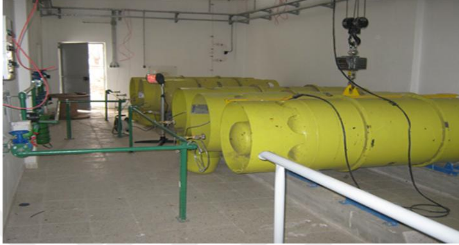
Şekil 6.9: Arsenik arıtma tesisi klor binası.
