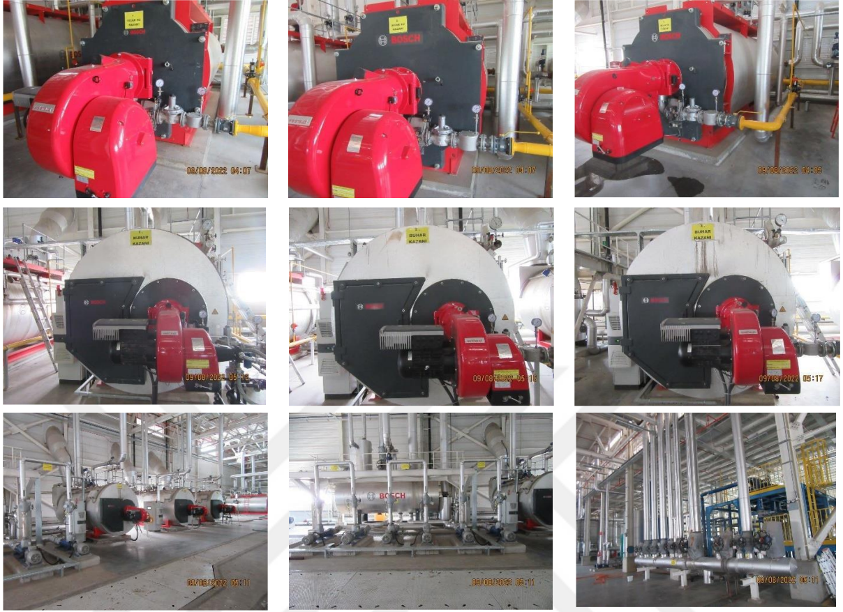
Şekil 41: Sıcak Su ve Buhar Kazanları
