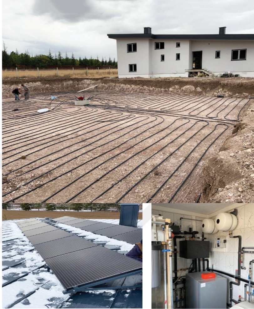
Şekil 24: Ankara Karacaoğlan Villa Projesinde Uygulanan Toprak Kaynaklı Isı Pompası ve Pv-Hibrit
