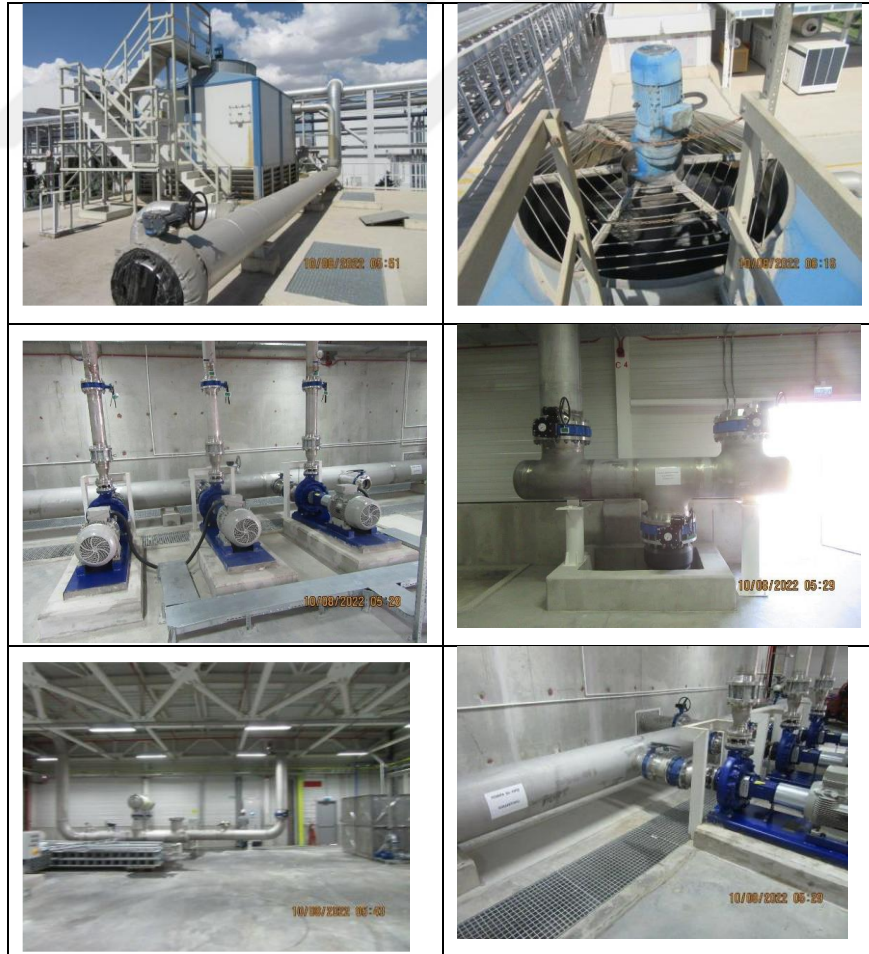
Şekil 47: Tesiste Bulunan Soğutma Kulesi ve Bağlantı
