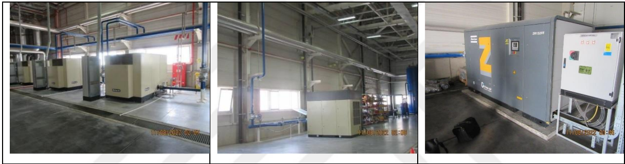
Şekil 53: Tesisteki Basınçlı Hava Sistemi
