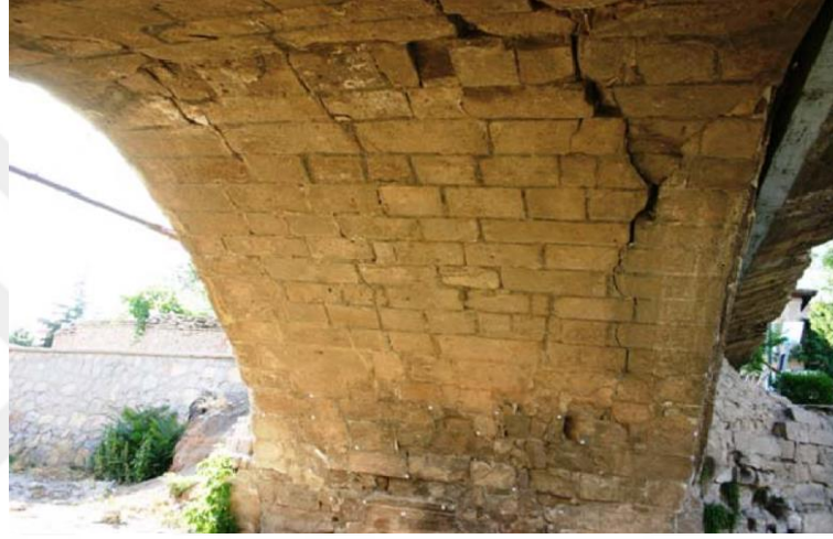
Şekil 4. 7. Restorasyon öncesi ana kemer yapısında meydana gelen çatlaklar (Ural, 2012).
