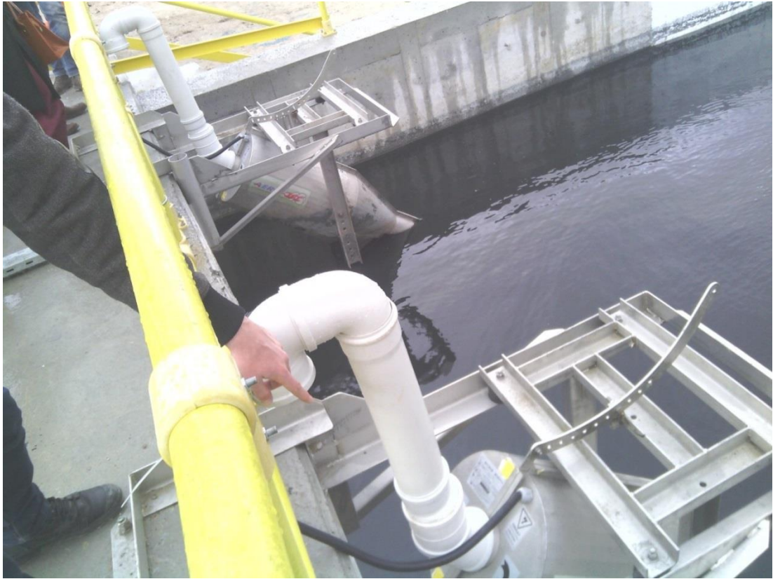
Şekil 2.7: Aksaray organize sanayi bölgesi tesis blower görüntüsü.
