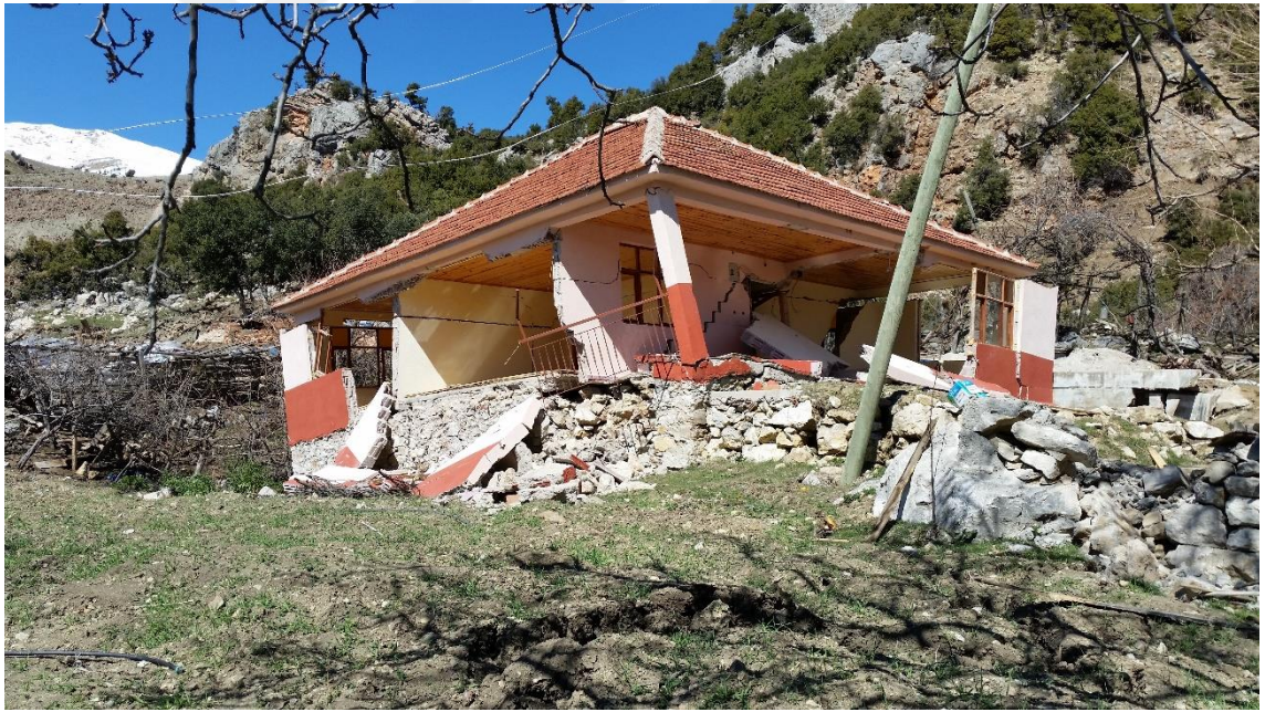
řekil 4.20. Meydana gelen heyelana ait tahribat g r nt leri (2 nolu heyelan noktası)
