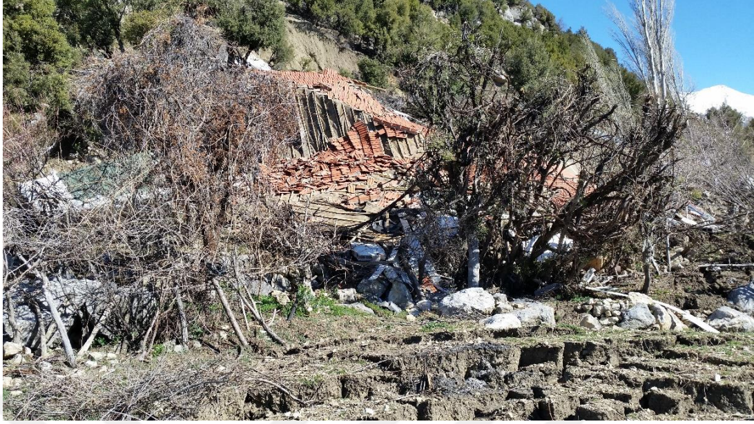
řekil 4.21. Meydana gelen heyelana ait tahribat grntleri (3 nolu heyelan noktası)
