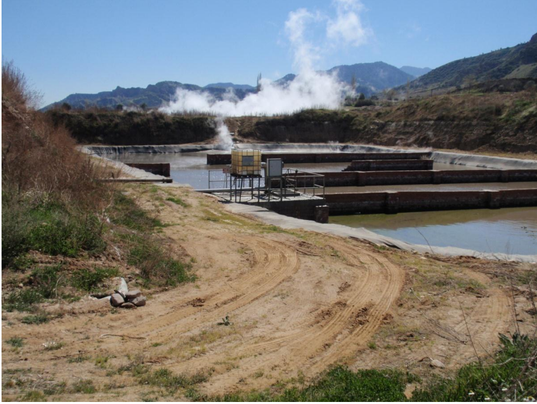
Şekil 3.7 Jeotermal patlama meydana gelen kuyunun son durumu
