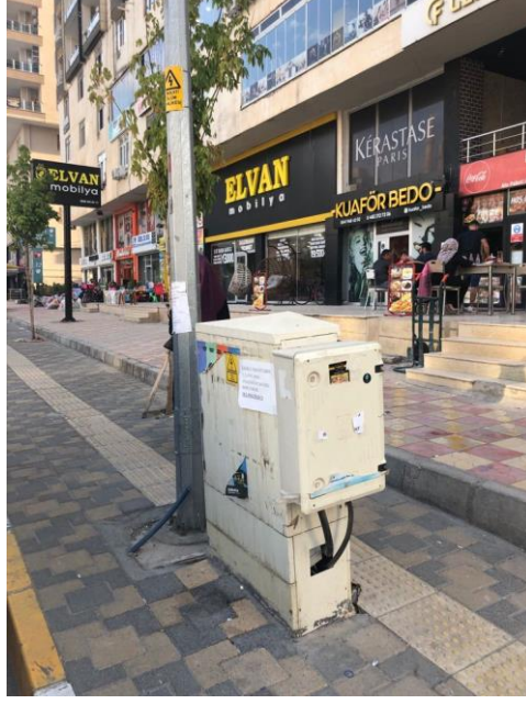
Şekil 3.3. Saha dağıtım panosu ve ek ikinci pano örneği
