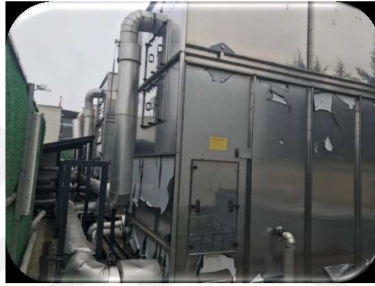
Şekil 4.5. Soğutma ünitesi (Soğutma Kuleleri)
