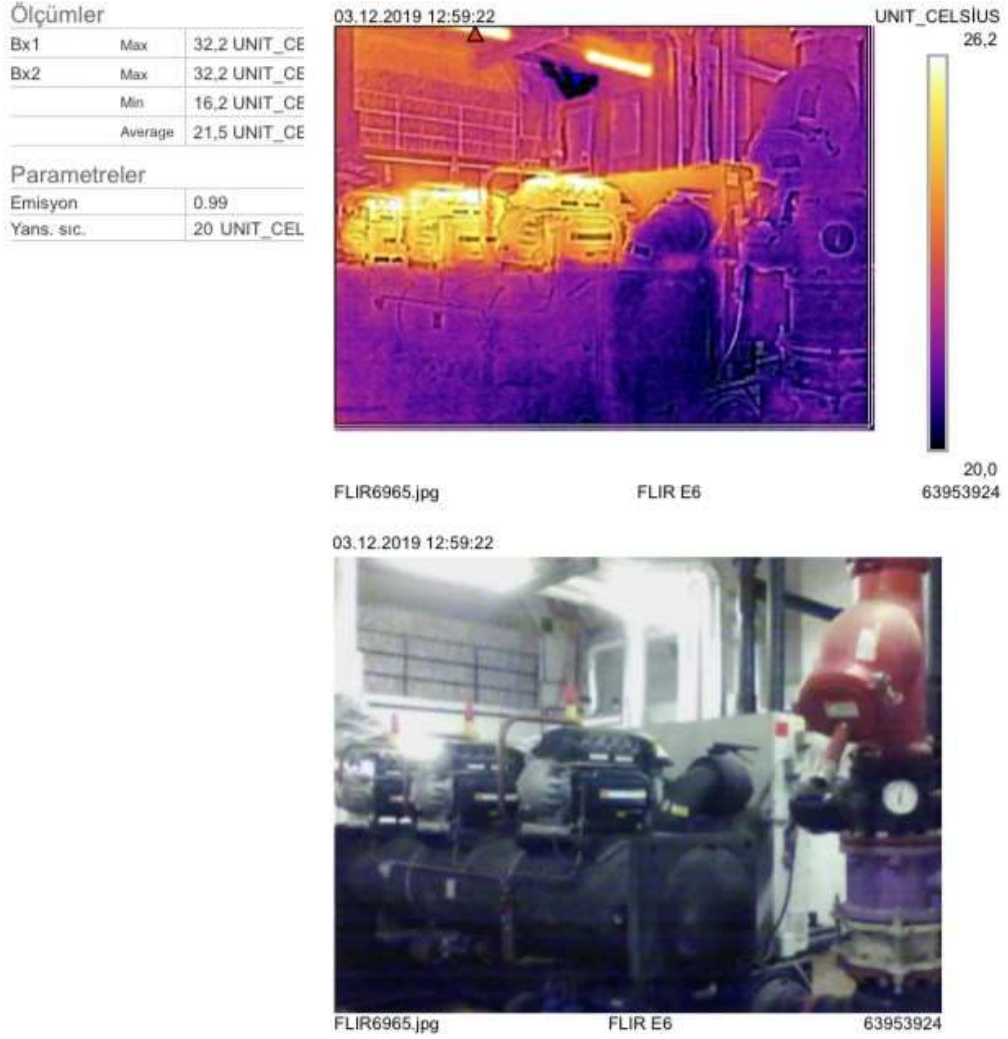
Şekil 4.8. Chiller Termal Görüntüleri
