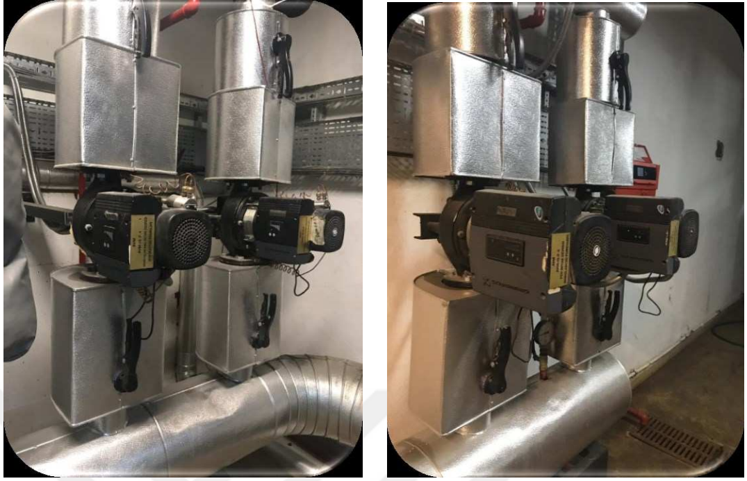
Şekil 4.14. Tesisatta kullanılan bazı elektrik motorları
