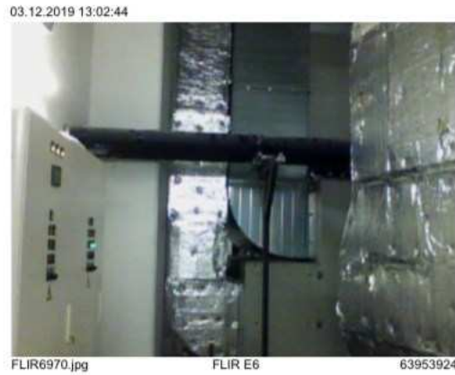
Şekil 4.10. Klima Santrali ve Havalandırma Kanalları Termal Görüntüleri
