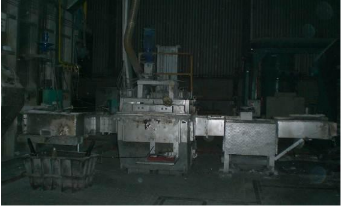
Şekil 6.2 Snif Gaz Alma ünitesinin Tutma Fırını ve Döküm Makinası arasındaki yeri
