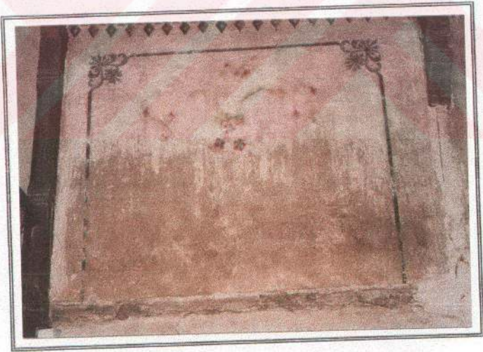
Fotoğraf 185 – Doğu duvarında en altta bulunan ve çoğu yeri dökülmüş olan kartuş
