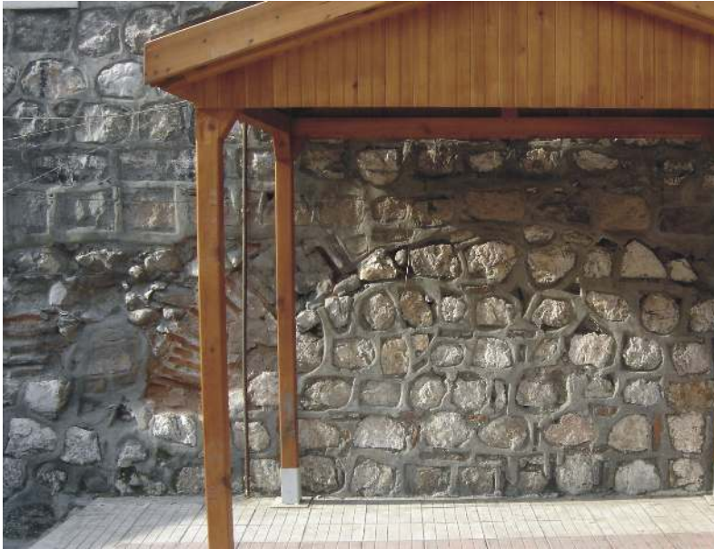
Resim 3.6. Güney cephesindeki kemer izleri (2007)
